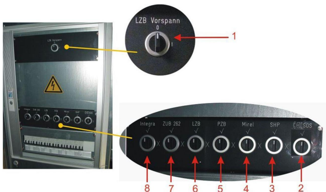
obr. 20 Skriňa vlakových zabezpečovačov v strojovni HKV typu Vectron [zdroj: Príručka na obsluhu rušňa X4-E]
