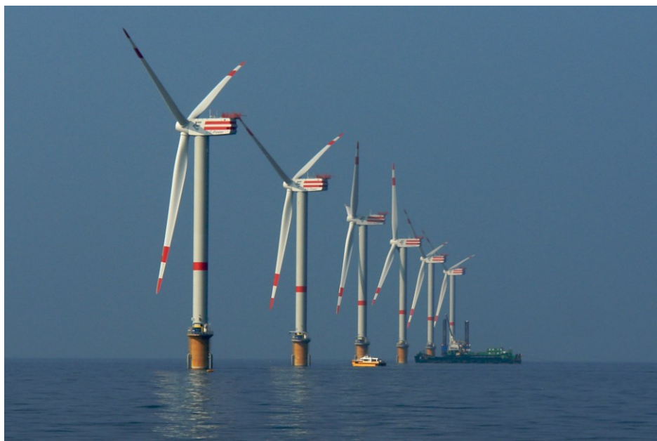
Obr. 1: Větrná elektrárna Thornton Bank [35]
