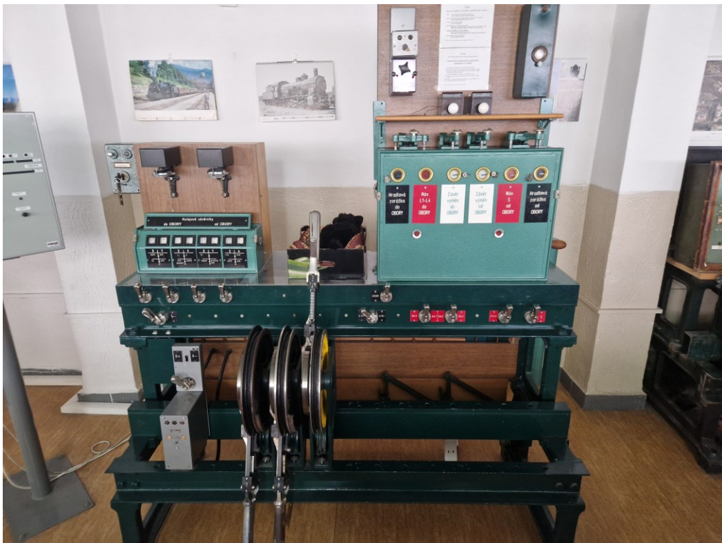
Obr. 5 Výhybkársky prístroj vzoru 5007 na stavadle číslo 2 (pozri tiež príloha 6)
