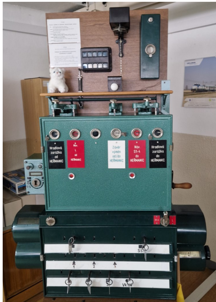
Obr. 7 Kľúčový prístroj s hradlovou skriňou na stavadle 1 (pozri tiež príloha 8)
