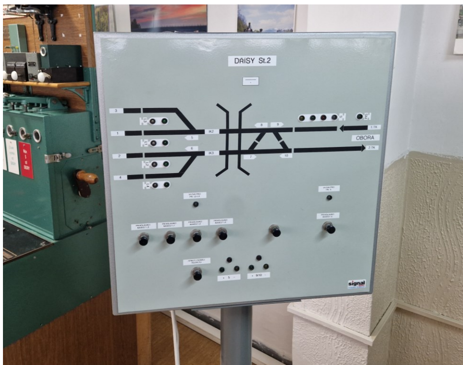
Obr. 6 Koľajová doska na stavadle číslo 2 (pozri tiež príloha 7)
