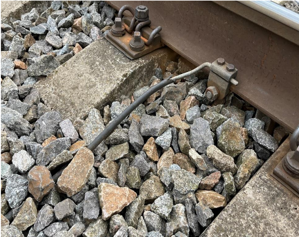
Obrázek 9 – uzemnění kolejnice před mostem
