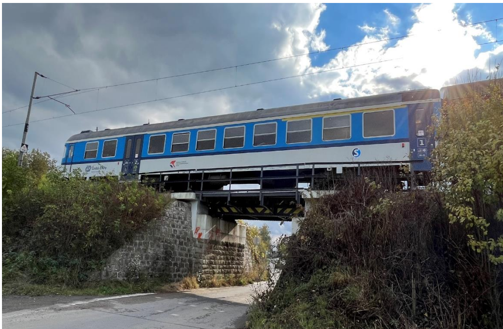
Obrázek 12 – konstrukce zatížená dopravou
