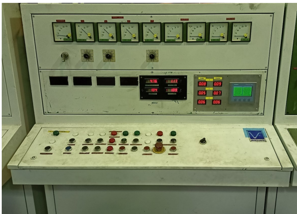
Obr. 2.40 – Ovládací pult s nainstalovaným HMI panelom
