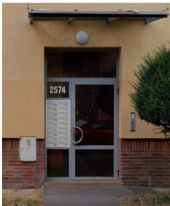
Obrázek 14 - Současný stav fyzického zabezpečení vchodových dveří
