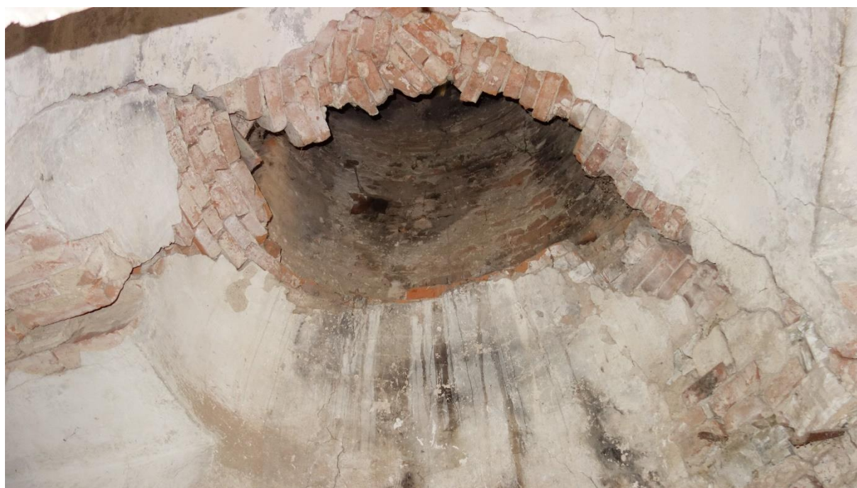
38. Prostor zaniklého vřetenového schodiště – pohled na destrukci klenby
