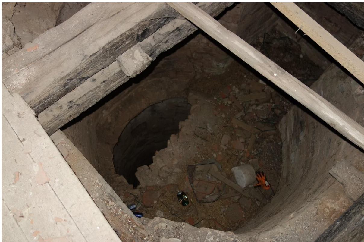
50. Pohled shora na destruovanou klenbu prostoru zaniklého vřetenového schodiště
