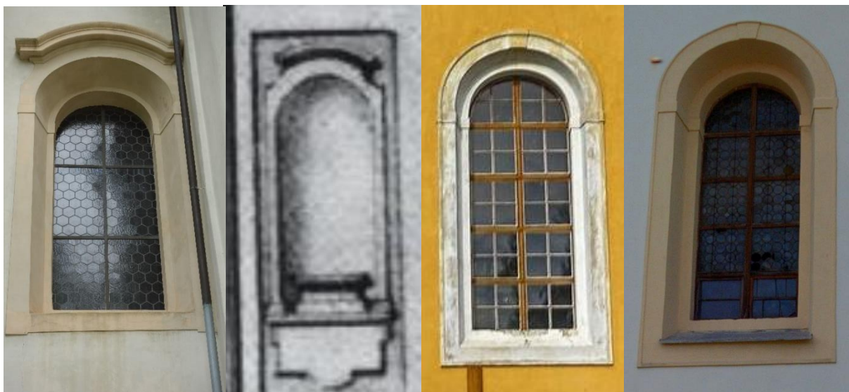
4. Šambrána okna lodi kostela Nanebevzetí Panny Marie na Loučeni (foto autor); šambrána niky západního průčelí kostela Nanebevzetí Panny Marie ve Svatoboru, výřez z návrhu F. M. Kaňky (VLČEK, Pavel. Slavné stavby Františka Maxmiliána Kaňky . Praha, 2016, s. 104.); nika okna lodi kostela sv. Havla v Tuhaní (Dostupné z: Kostel sv. Havla, Tuhaň. Mapy.cz [cit. 10.2.2024]. URL: < https://mapy.cz/turisticka?pano=1&source=base&id=2077948&gallery=1&x=14.4695176&y=50.5368501&z=19 >.); nika okna lodi kostela sv. Václava v Rychnově u Jablonce nad Nisou (Dostupné z Kostel sv. Václava, Rychnov u Jablonce nad Nisou. Mapy.cz [cit. 10.2.2024]. URL: < https://mapy.cz/turisticka?source=base&id=2069340&gallery=1&sourcep=foto&idp=252978&x=15.1487301&y=50.6869689&z=18 >.)
