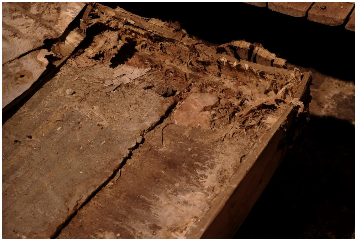
Obr. 5 Stav transferů v plochých bednách v místnosti 1 – napadení omítky dřevokaznou houbou
