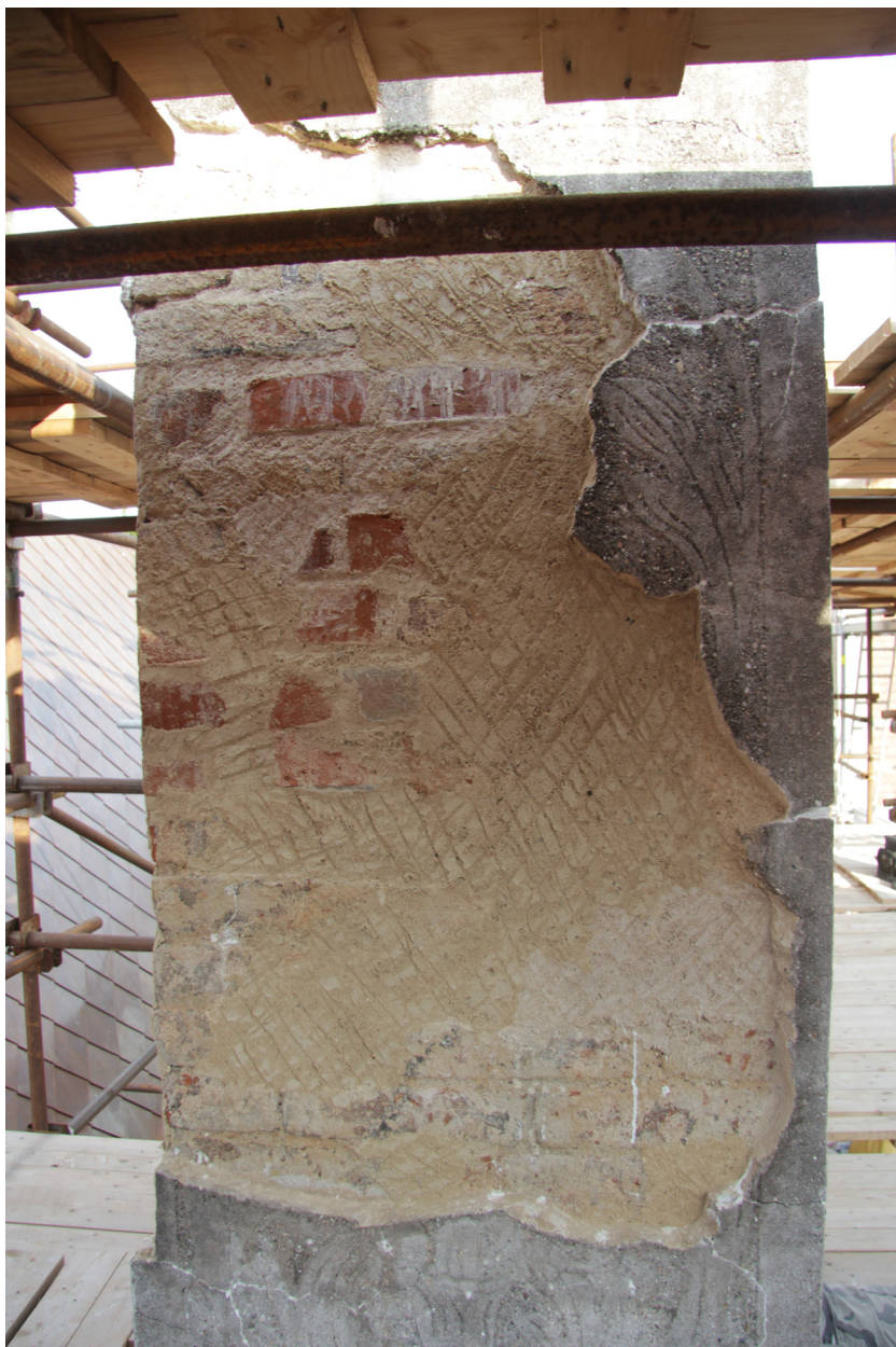
Obr. 54: Komín č. 2, západní strana, stav po doplnění zdiva a vytmelení jádrovu omítkou.
