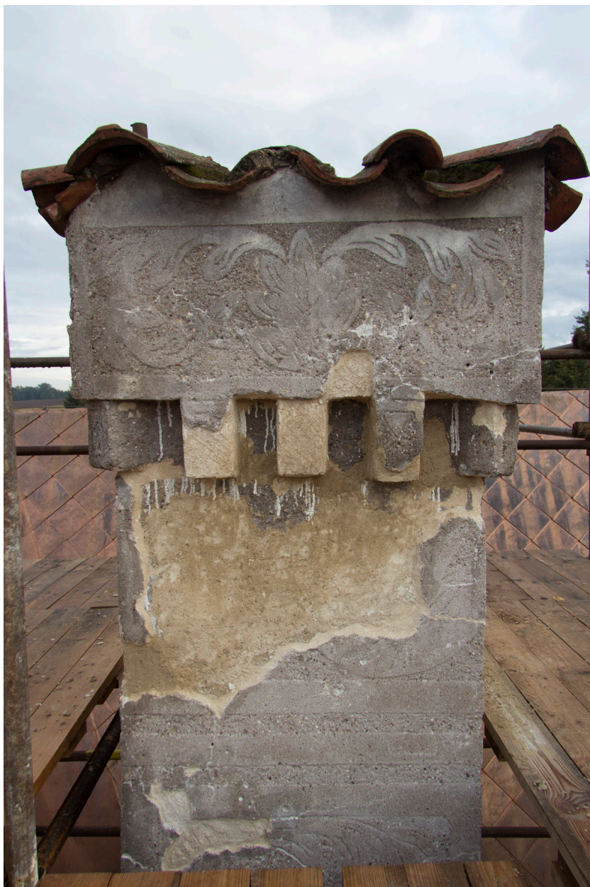
Obr. 52: Komín č. 2, jižní strana, po vytmelení já- drovou omítkou.
