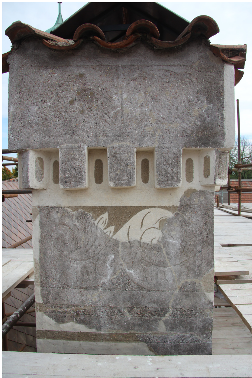
Obr. 68: Komín č. 2, západní strana. Stav po konzervaci, vytmelení defektů a provedení rekonstrukce chybějících částí.
