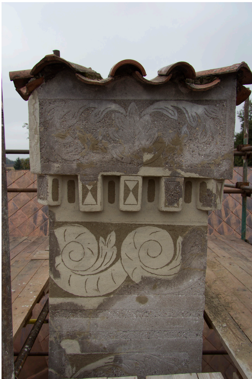
Obr. 60: Komín č. 2, jižní strana. Stav po konzervaci, vytmelení defektů a provedení rekonstrukce chybějících částí.
