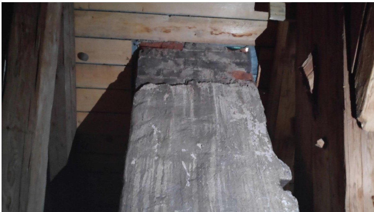
Tělo komína v prostoru střechy, komín není stabilizován v rovině střechy
