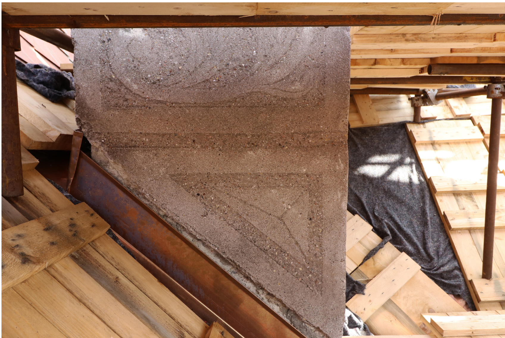
Obr. 23: P a t a komínu č. 2, jižní strana. Stav před restaurováním.
