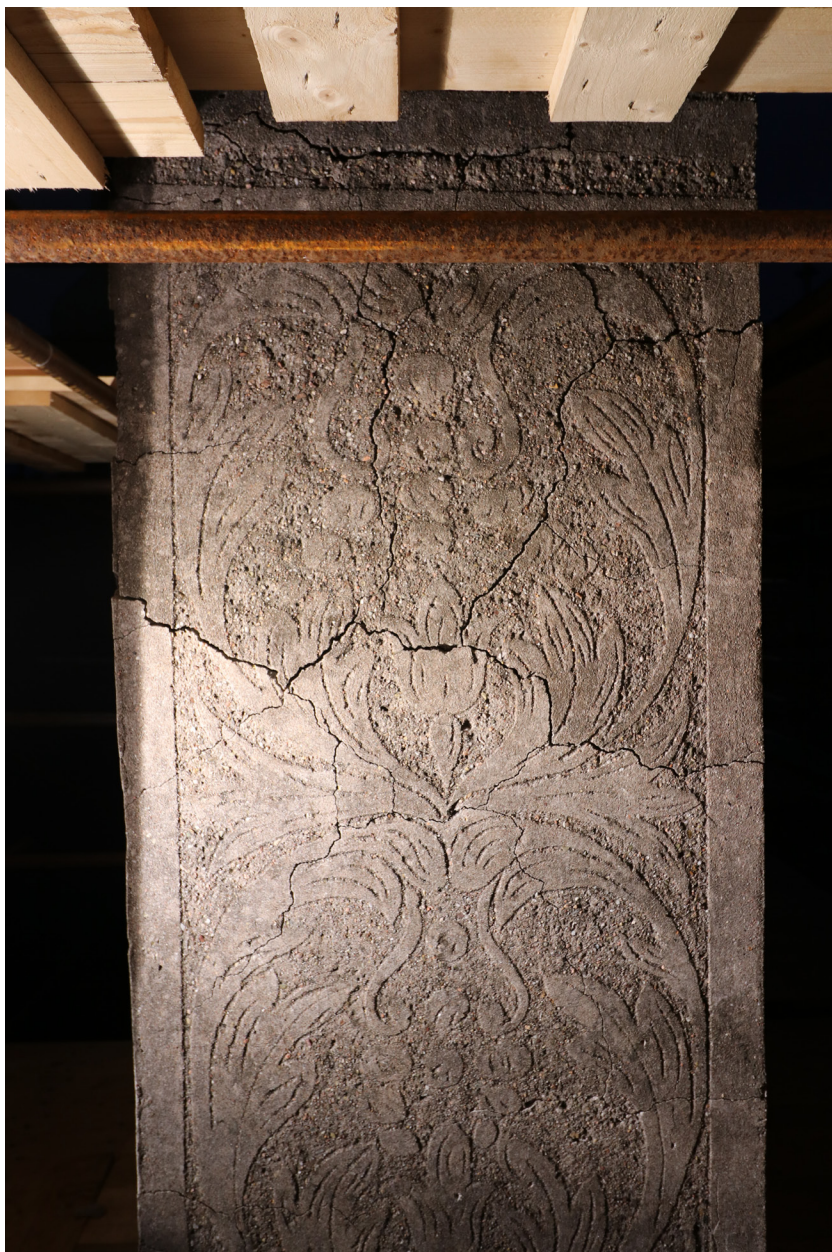
Obr. 44: Komín č. 2, západní strana, foto v ostrém bočním světle. Při bočním nasvícení lze lépe pozorovat dochovaný dekor.
