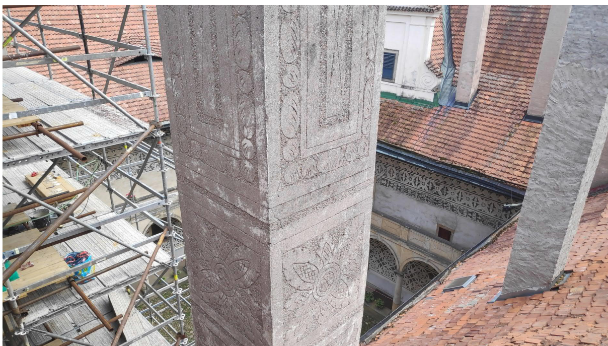
Pohled na trhliny v sgrafitové omítce
