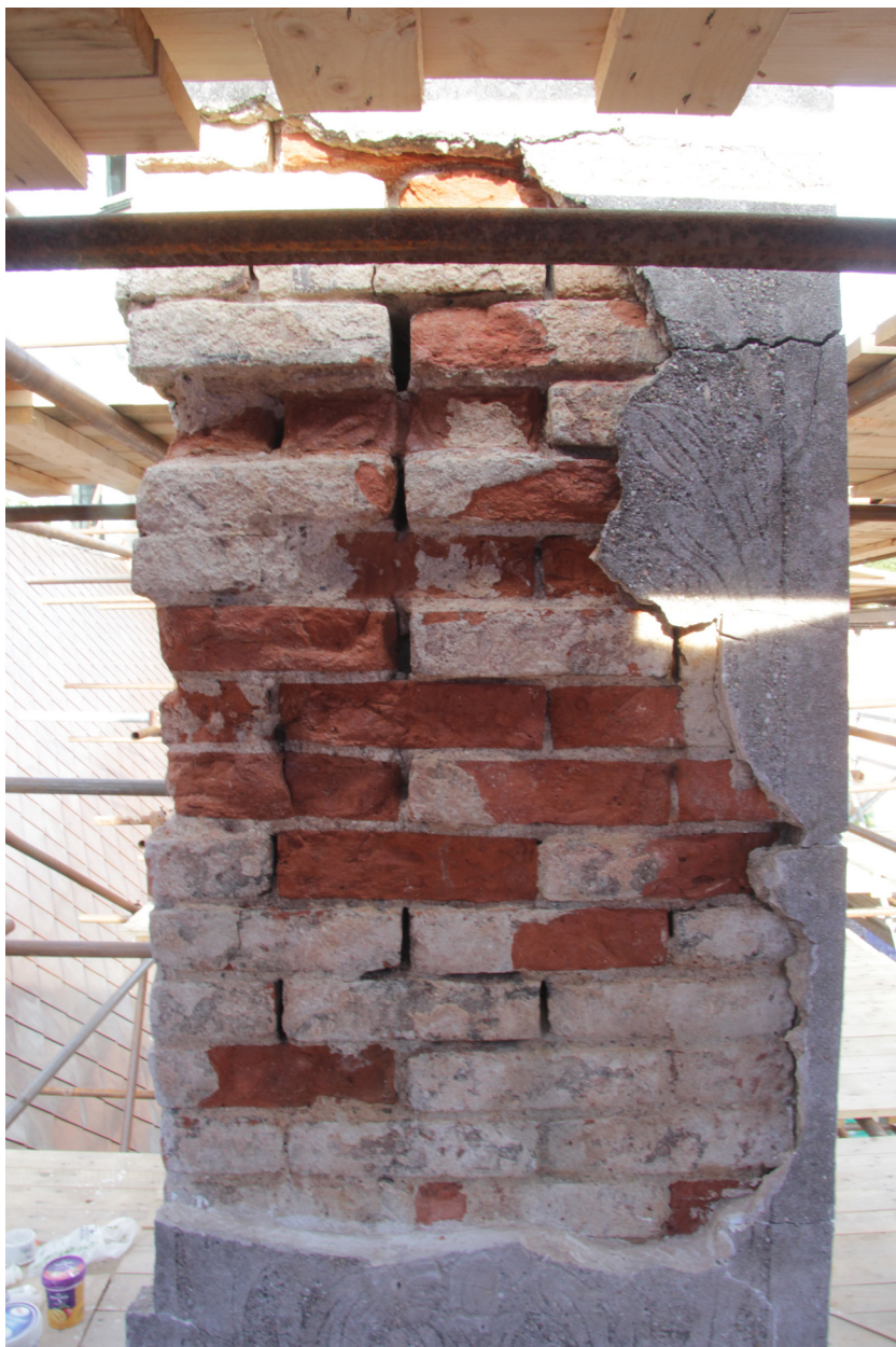
Obr. 46: Komín č. 2, západní strana, detail po odstranění nesoudržné omítky, strukturálním zpevněním a injektáží. V průběhu zajišťování okrajů defektu tmelením.
