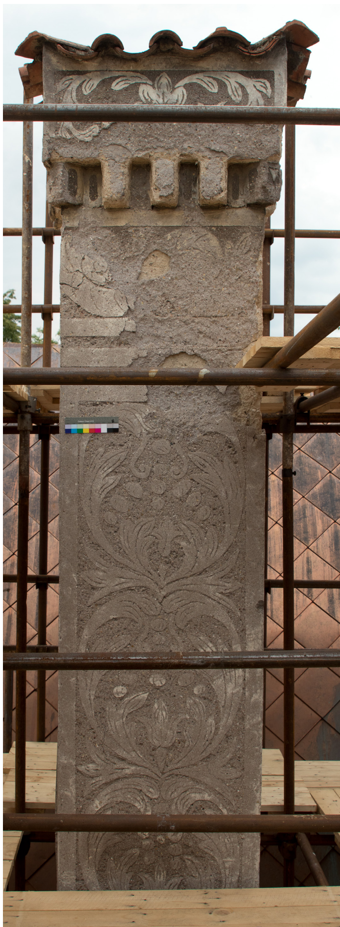
Obr. 24: Horní polovina komínu č. 2, východní strana. Stav před restaurováním.
