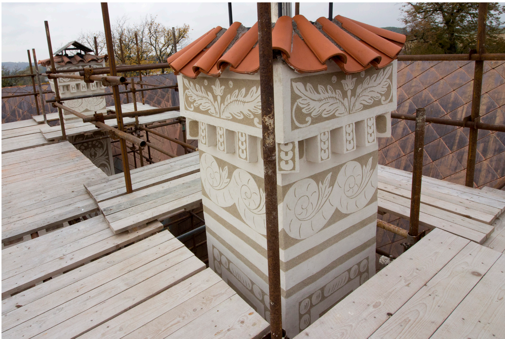
Obr. 12: Horní část komínu č. 1 po rekonstrukci sgrafitové výzdoby. Jižní a východní strana.
