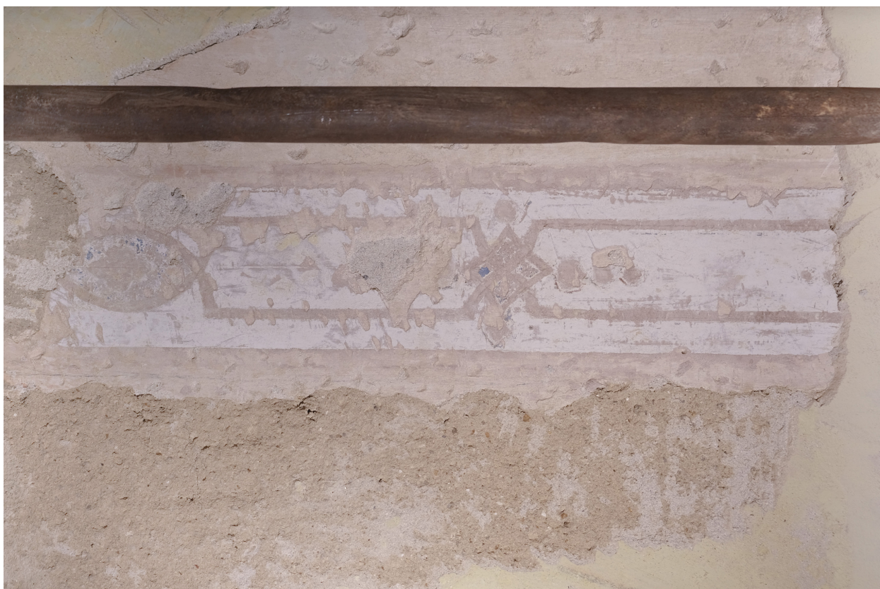
Obr. 57: Snímek dokumentující detail původní barokní omítky, která byla v rámci úprav prostoru kaple poškozena druhotným pekováním.
