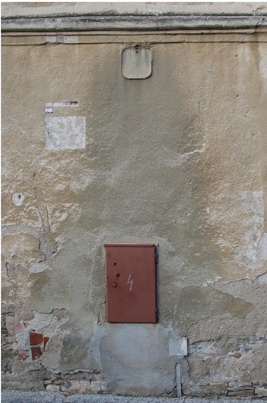
Obr. 26: Narušení fasády domu elektrickou rozvodovou skříní v přízemí domu.
