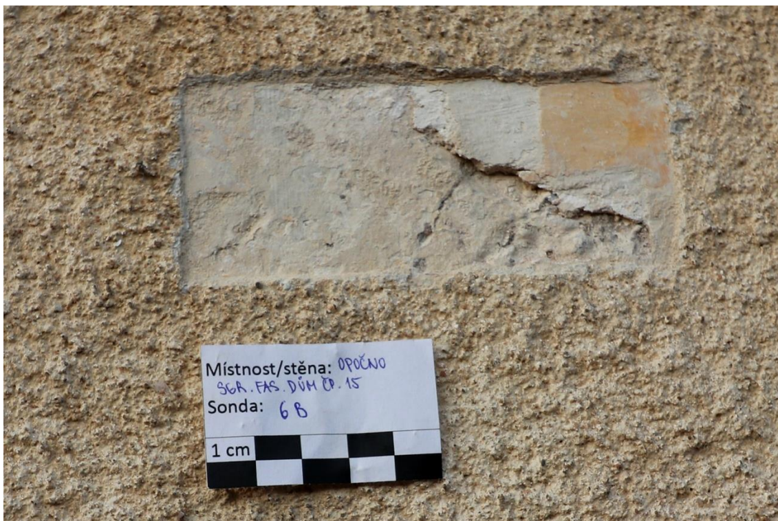
Obr. 5: Sonda S6B v prvním patře domu nad prostředním oknem dokumentující různý stupeň dochování starších druhotných vrstev.
