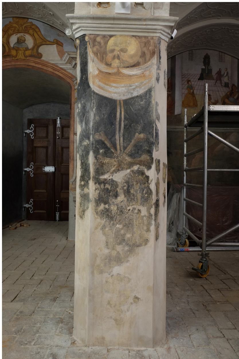
Obr. 107: Centrální pilíř: celkový pohled ze SV. Stav po čiště- ní a tmelení.
