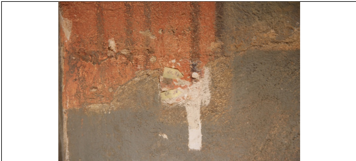
Obr. 11 Lokalizace míst měření Ok 27 a Ok 28, levá luneta, špaleta dole vlevo, předěl omítek.
