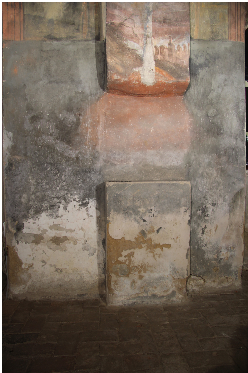
Obr. 05: SV stěna: celkový pohled na horní partii centrální části. Stav před restaurováním.
