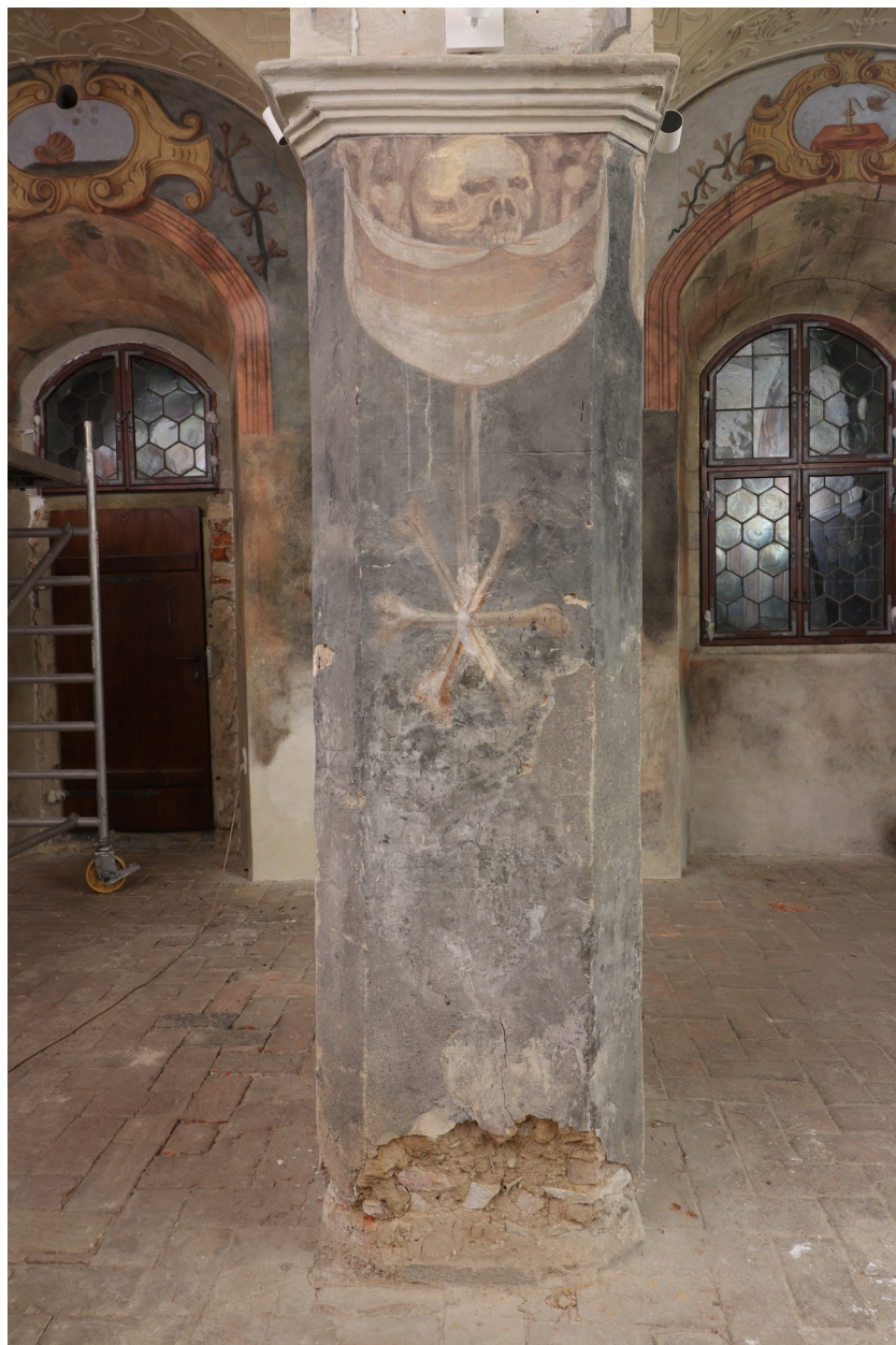
Obr. 13: Centrální pilíř: celkový pohled ze SZ. Stav před restaurováním.
