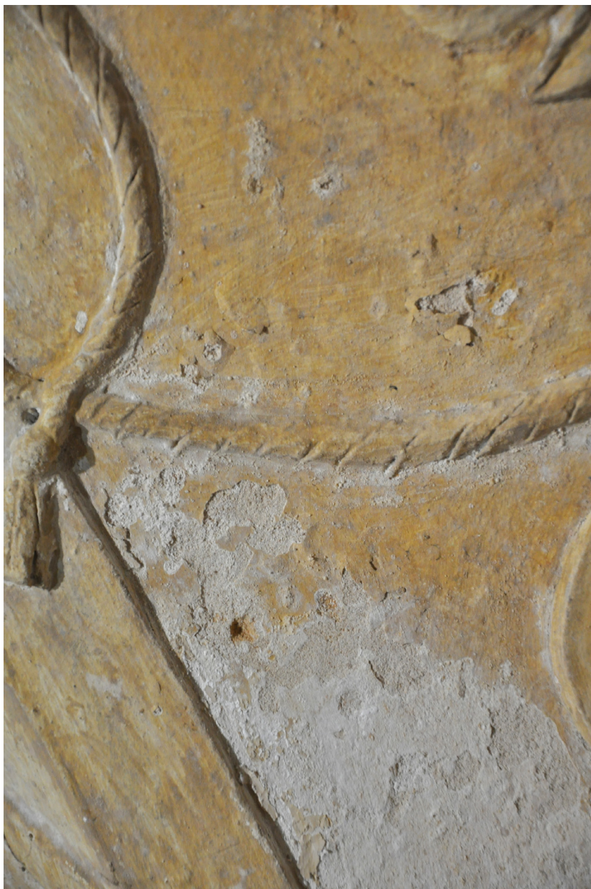
Obr. 47: Štuková výzdoba stropu: detail puchýřovitění a následné ztráty barevné vrstvy.
