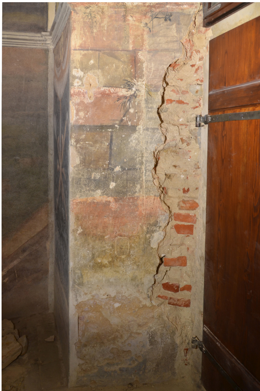
Obr. 83: SV stěna: levá část dveřní špalety. Stav čištění a odstranění druhotných zásahů.
