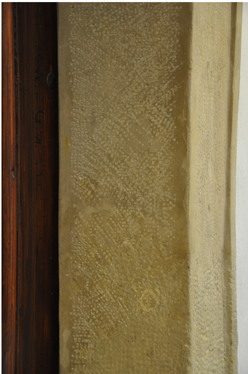
Obr. 50: Kamenný portál: detail nedostateč- ně zpracované- ho sekundárního tmelu v horní části levé strany portálu při po- hledu z interiéru kaple.
