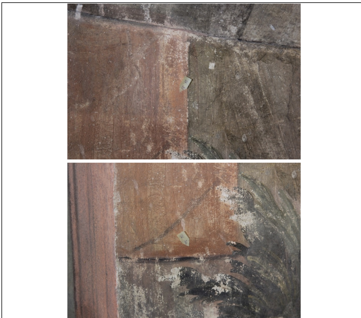
Obr. 13, 14 Lokalizace míst měření Ok 31 a Ok 32, levá špaleta vlevo, horní roh, iluzivní architektura.
