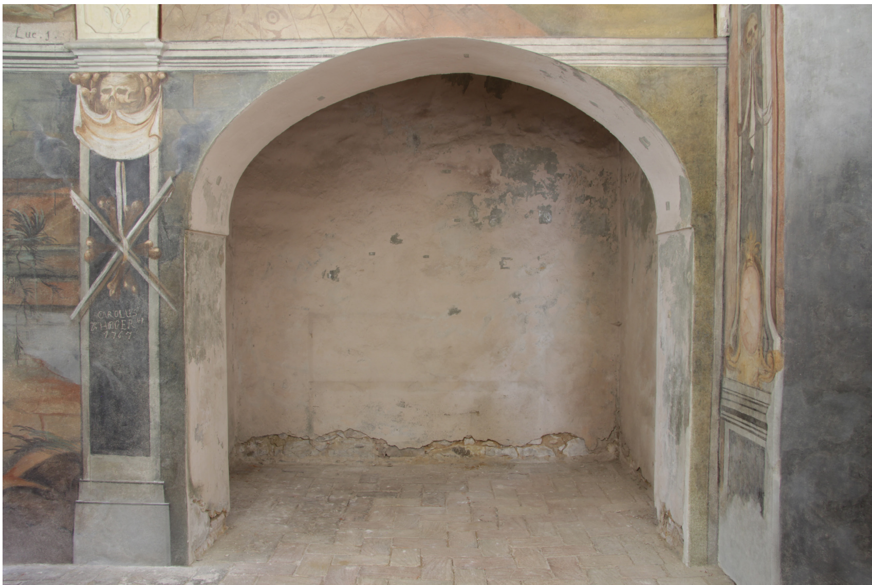
Obr. 08: JV stěna: celkový pohled na výklenek a zbylou výmalbu v dolní části stěny. Stav před restaurováním.
