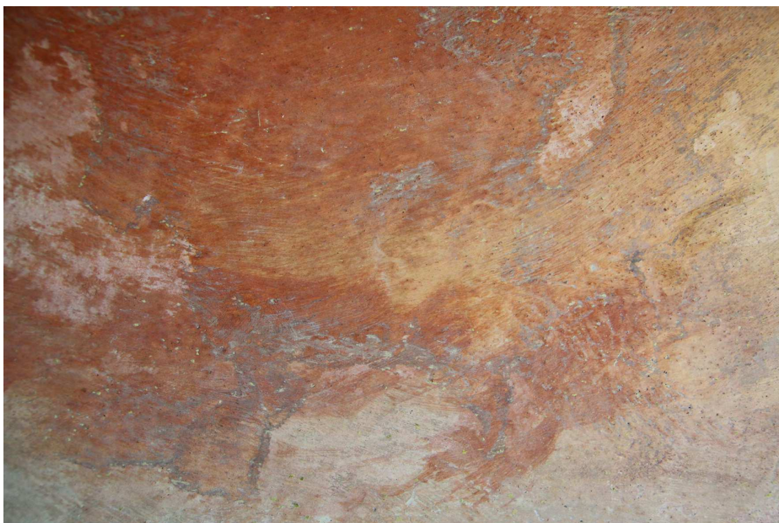
Obr. 27 Šedý zákal a mapy v oblasti oblohy, způsobené patrně zatečením vody. Stav po sejmutí přemalby z 19. stol.
