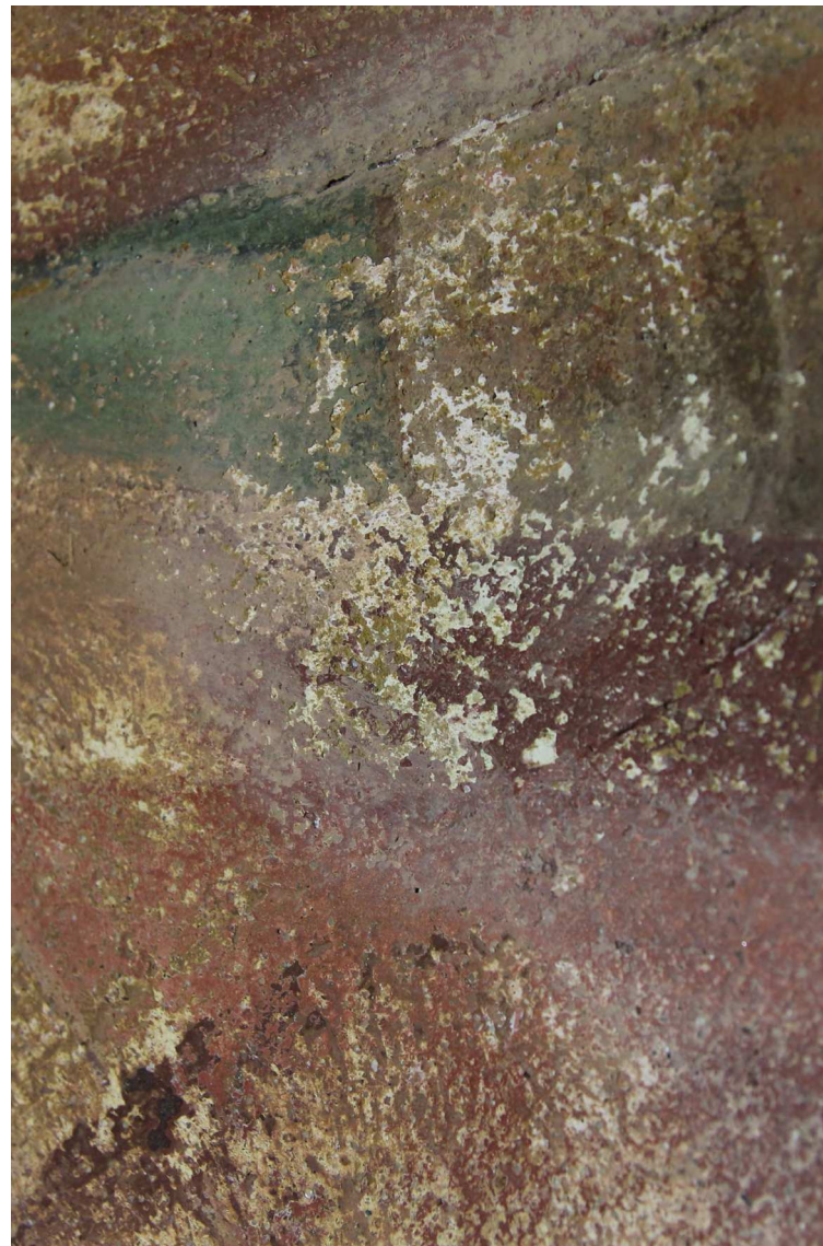
Obr. 29 Poškození zpráškovatěné barevné vrstvy z 19. století. Stav před restaurováním.
