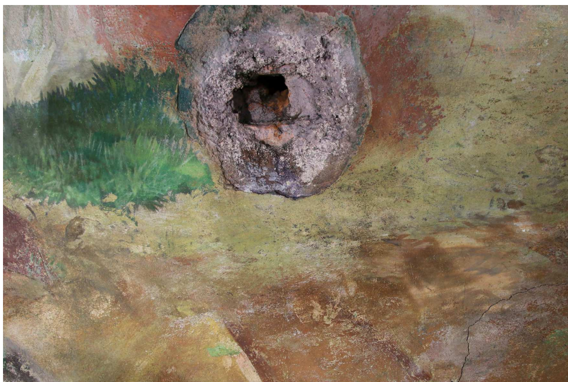
Obr. 22 Chybějící omítková vrstva na klenbě. V jejím středu se nachází otvor do podstřešního prostoru kaple, přes který byla jištěna dřevěná plastika polopostavy Boha Otce. Na chybějící omítce je viditelný nános barevné vrstvy z přemalby. To prokazuje, že toto poškození bylo způsobeno ještě před nanesením přemalby z 19. století. Stav v průběhu odstraňování přemalby z 19. století.
