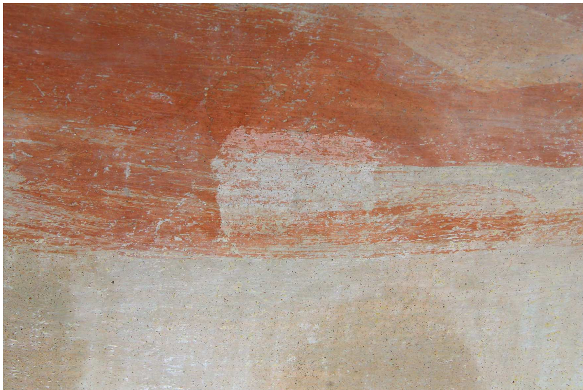
Obr. 41 Zkoušky odstranění přemalby z 19. stol. Po sejmutí zábalu z iontoměniče Amberlite 4400 OH se projevilo poškození (odbarvení) barokní barevné vrstvy v důsledku styku iontoměniče s původní barevnou vrstvou. Oblast oblohy. Stav v průběhu zkoušek technologií a materiálů.
