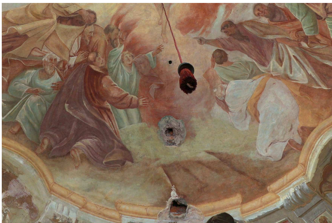
Obr. 98 Stav po restaurování. Spodní polovina nástropní malby.
