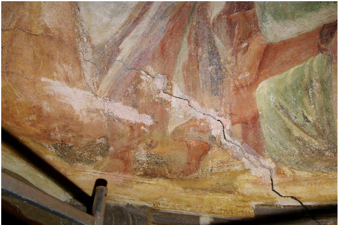
Obr. 55 Detail oblasti s bílým tmelem po odstranění tmelu - ztráta barokní barevné vrstvy.
