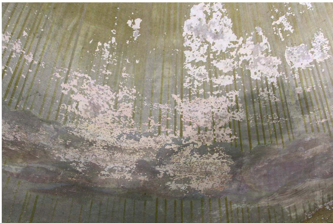
Obr. 23 Poškození přemalby z 19. stol. - odlupování a úplná ztráta barevné vrstvy. Oblast oblohy. Stav před restaurováním.
