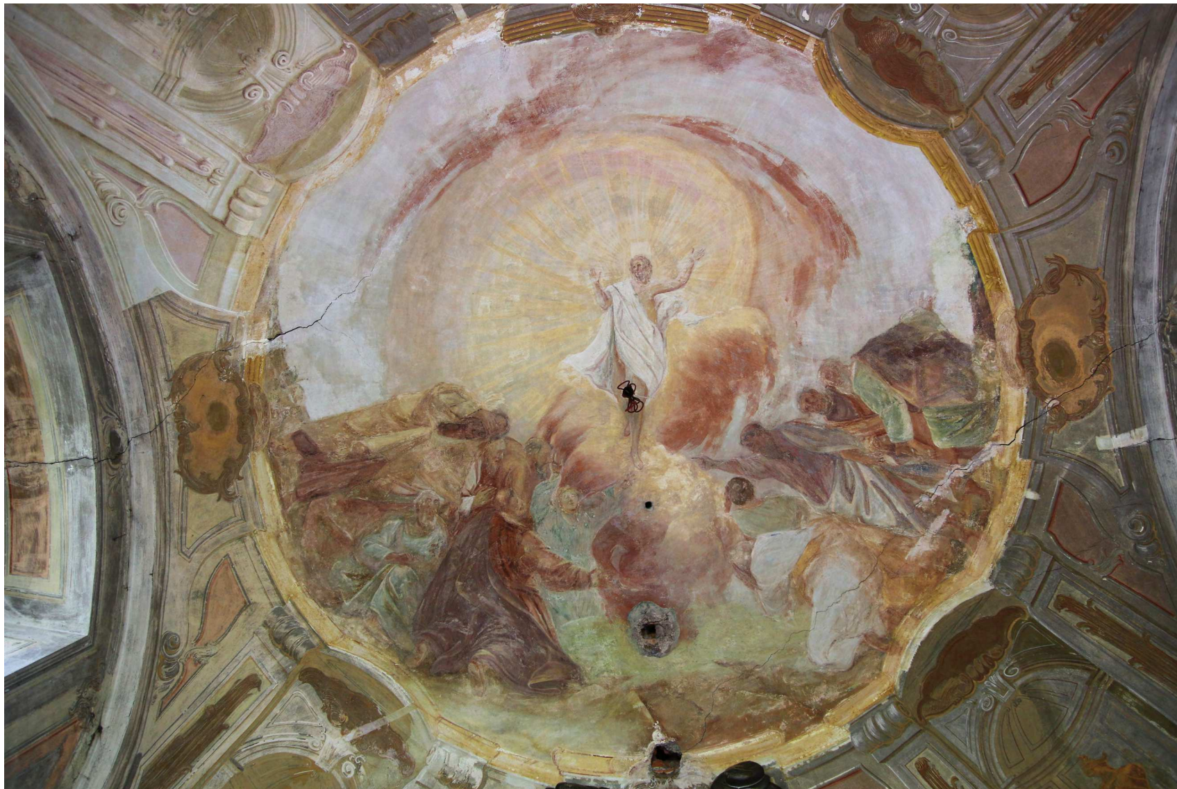
Obr. 56 Celkový pohled na nástropní malbu po odstranění přemalby z 19. století a druhotných vrstev.
