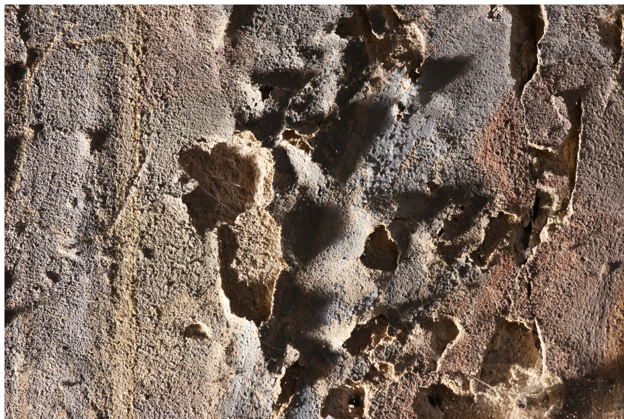
Obr.25 Průzkum v ostrém bočním nasvícení v levé horní části východní stěny, které podpořilo strukturu barokní vrstvy a zdůraznilo puchýřovitění intonaca s barevnou vrstvou.
