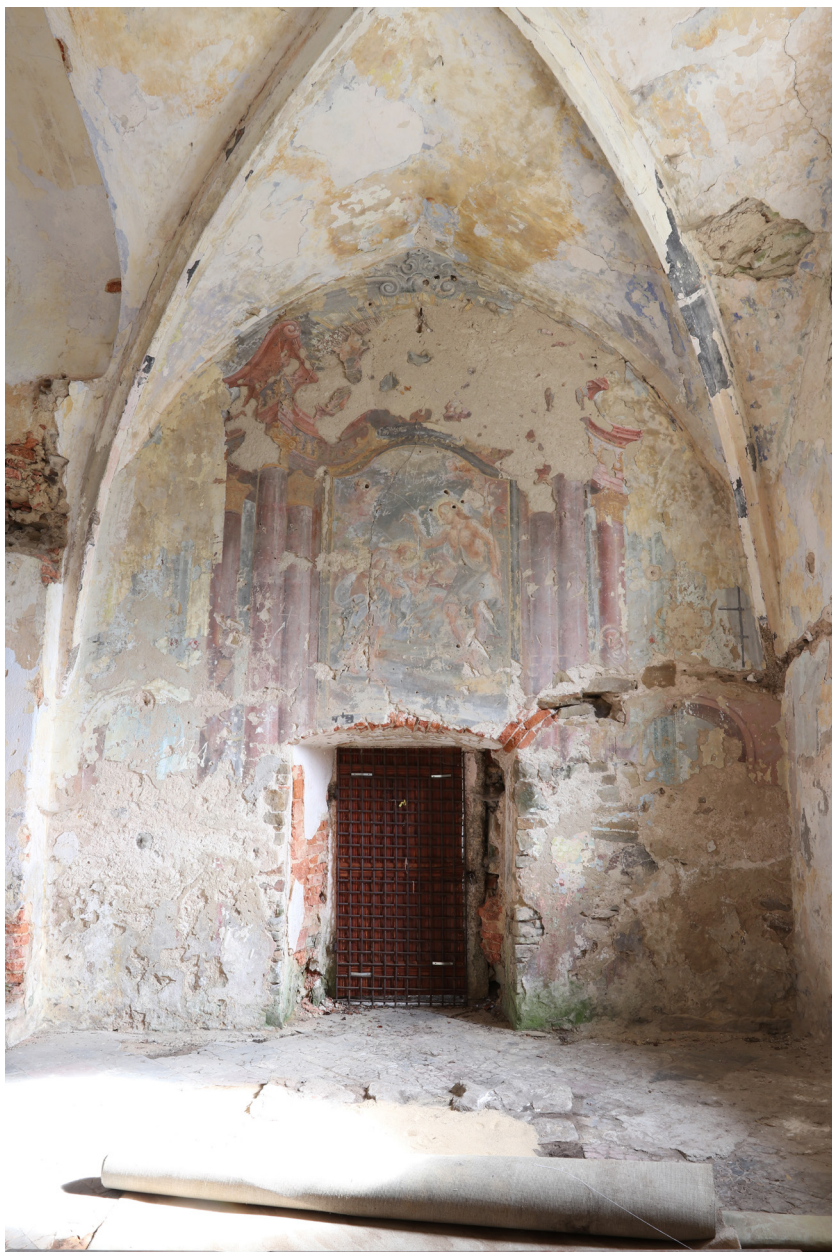
Obr. 14 Celkový pohled na východní stěnu presbytáře. Na fotografii je patrný celkově havarijný stav omítkových a barevných vrstev.
