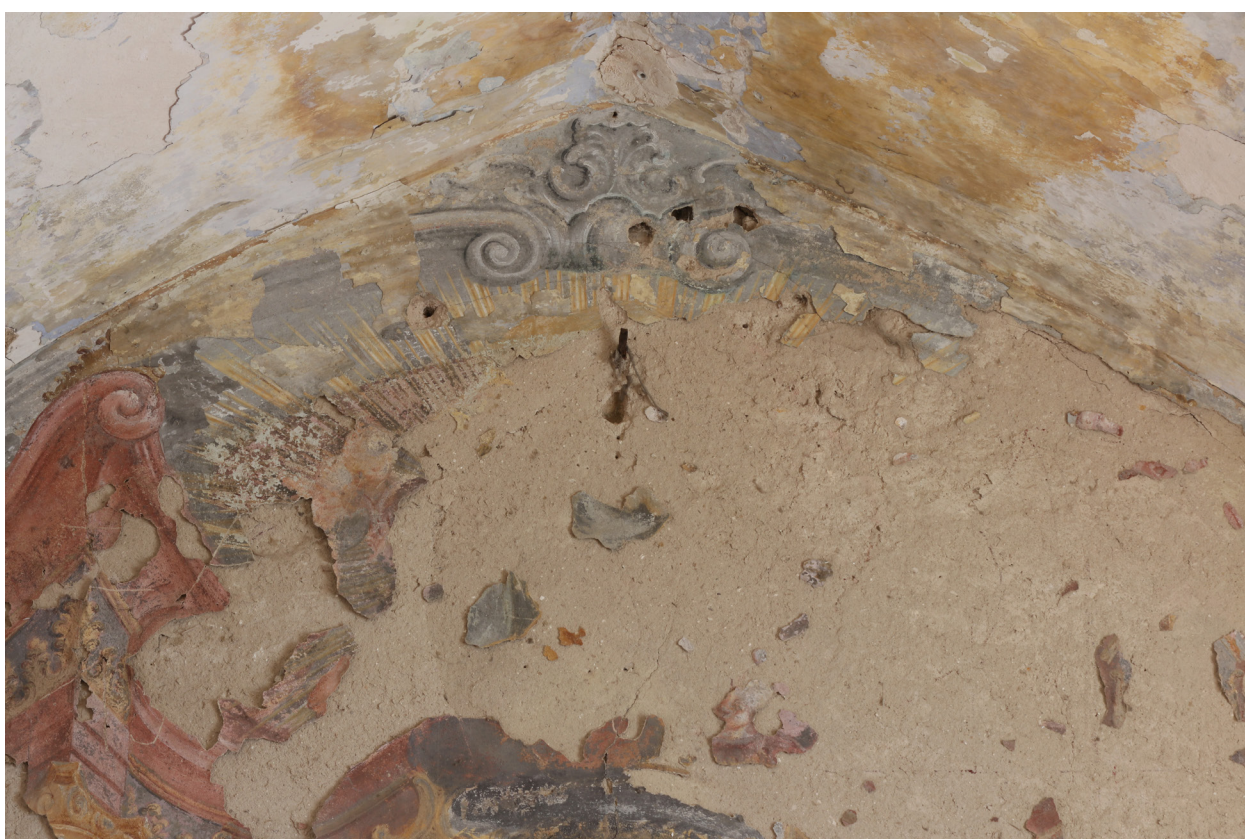
Obr.23 Detail jihovýchodního rohu presbytáře. Na snímku je pozorována barokní výmalba vyobrazující iluzivní okno, dále je patrné poškození v podobě ztráty materiálu kamenného žebra, mechanického poškození, či ztráty omítkových a barevných vrstev.
