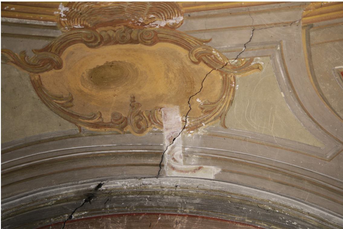
Sondy - odstranění přemaleb z iluzivní architektury - v sondách patrné barokní malby.
