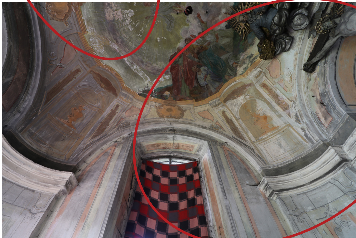
Architektura okolo figurální kompozice - barokní malba s přemalbou z 19. století. Ta je z části poškozená od mechanického čištění, které bylo provedené patrně ve 20. stol. (označená oblast).
