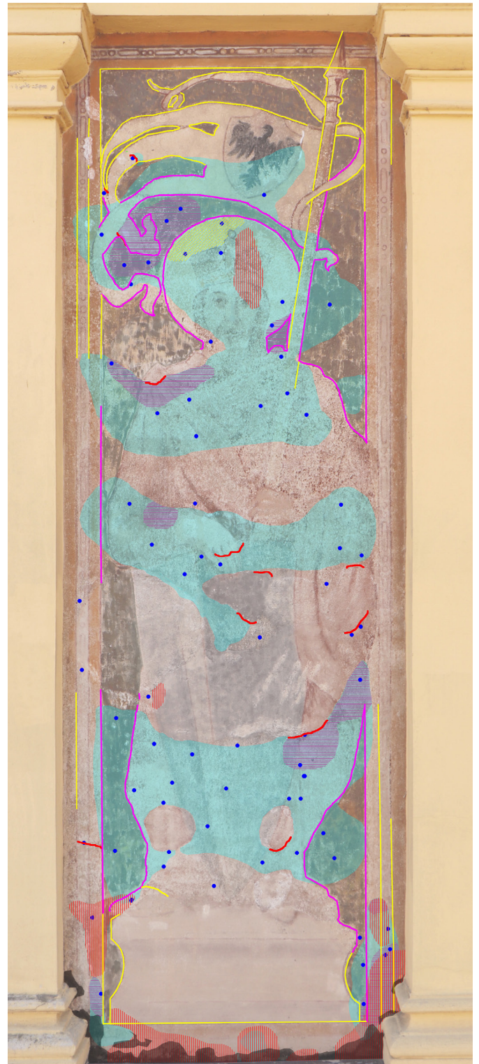
Obr. 121: Grafický zakres poškození, injektáží (2017) a ryté kresby malby sv. Václava.
