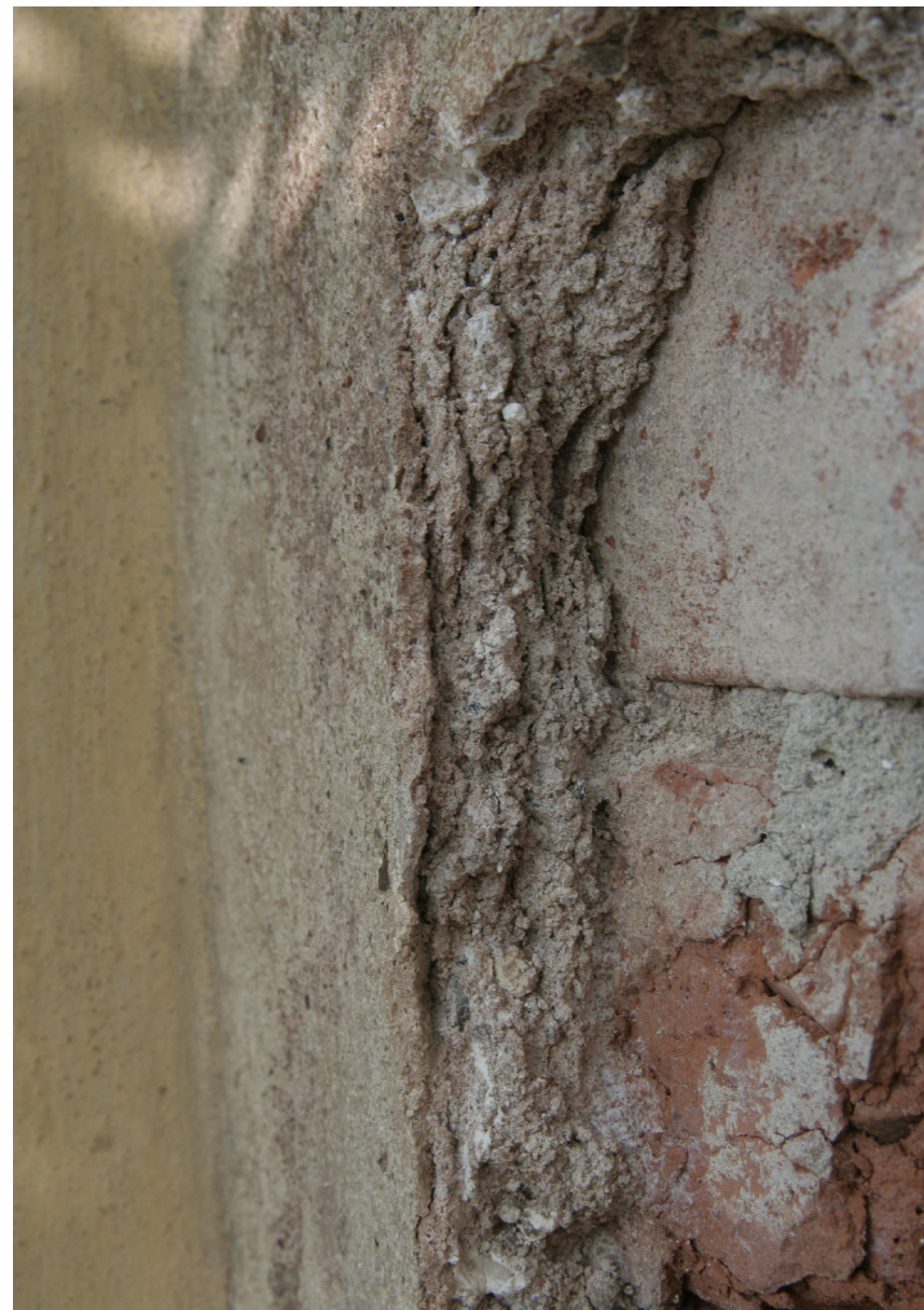
Obr. 57: Detail části omítky malby sv. Václava po odstranění starých tmelů. Zde došlo k ztrátě koheze a adheze omítky v tenkých plátech.
