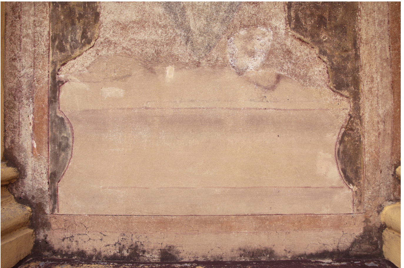
Obr. 84: Část malby sv. Václava - sokl, před restaurováním. Fotografie v denním světle.
