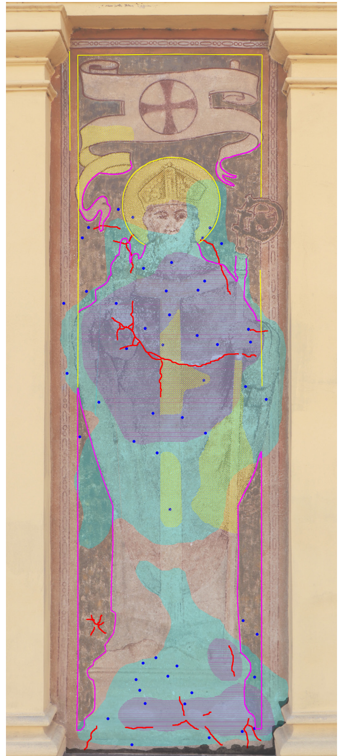
Obr. 123: Grafický zakres poškození, injektáží (2017) a ryté kresby malby sv. Vojtěcha.
