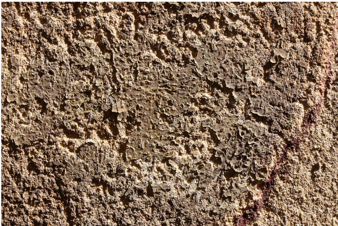
Obr. 42: Detail části zlaceného pozadí sv. Vojtěcha - nad rameny, v ostrém bočním nasvícení před restaurováním. V bočním nasvícení vynikla hrubá struktura omítky a degradace kovové povrchové úpravy, která se zachovala jen na vršcích omítky. Kov se také od povrchu zvedá v šupinách.
