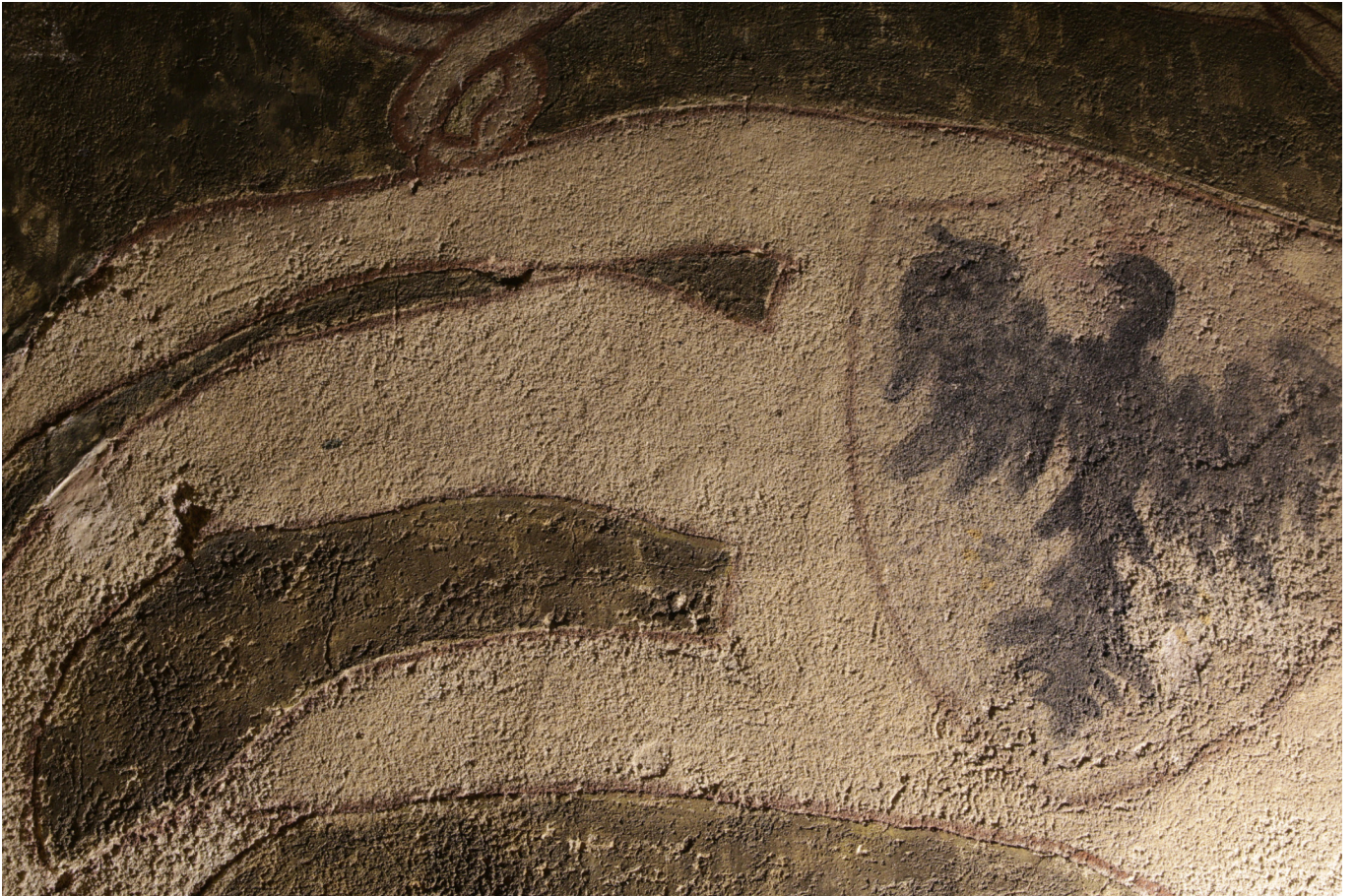
Obr. 34: Horí část malby sv. Václava - prapor, v ostrém bočním nasvícení před restaurováním. Po obvodu praporu je vidět reliéfně vystupující zlácené plochy pozadí. Také byly zvýrazněny hlubkové defekty v omítce.
