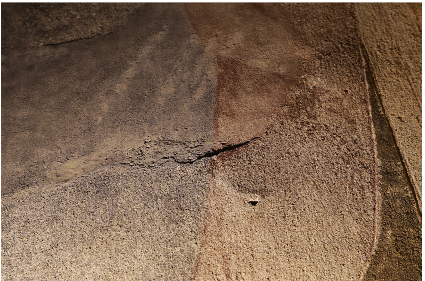
Obr. 37: Část malby sv. Václava - štít a draperie, v ostrém bočním nasvícení před restaurováním. Světlo zvýraznilo odlišnou strukturu omítek tmelu a originálu. Zvýraznil se také zdvižený okraj originální omítky oddělené od tmelu.
