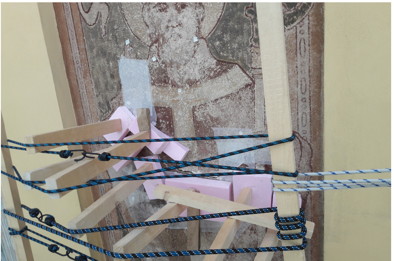
Obr. 55: Postup injektážních prací na malbě sv. Vojtěcha. Přítlak za pomoci prakovací metody pomáhá k částečnému navrácení zdvižené omítky do původní roviny.
