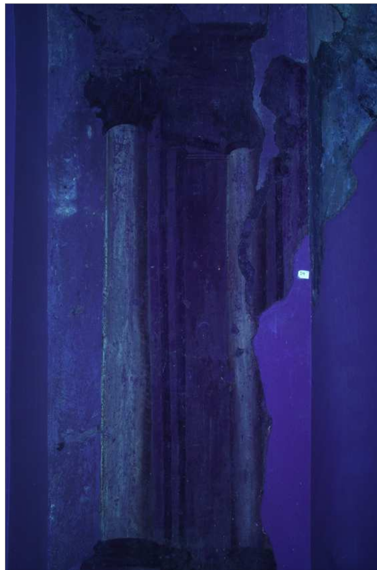
Obr. 40 Střední část levé restaurované stěny. Vizuální průzkum v UV záření. Stav po odkryvu.
