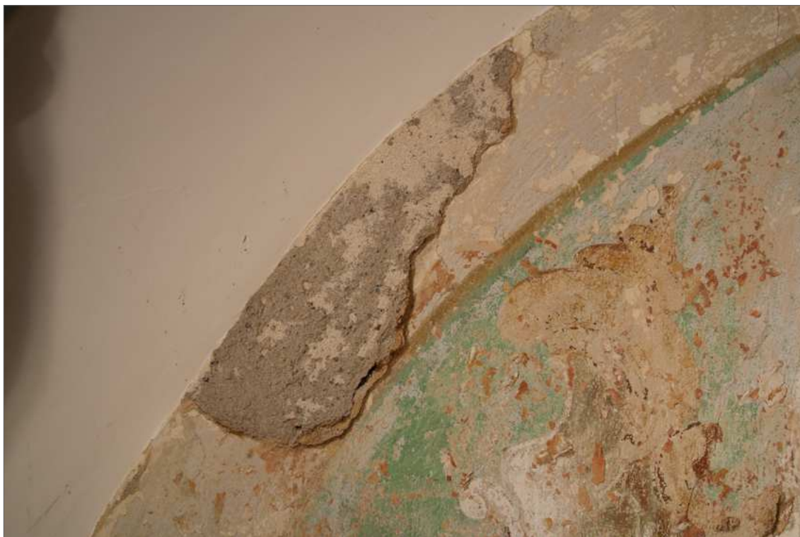
Obr. 30 Tmel cementového charakteru v oblasti levé horní části steny. Stav po odkryvu.
