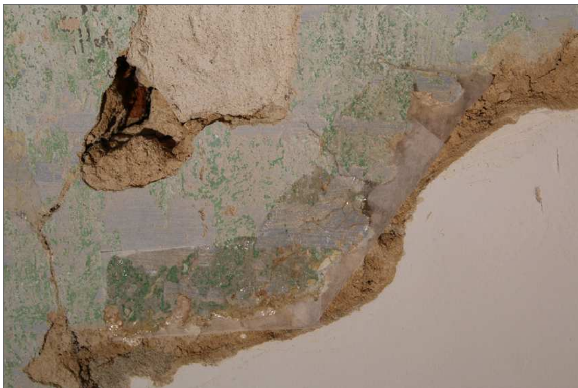
Obr. 63 Přeplepy z japonského papíru přichycené 5% (hm.) roztokem Tylosy MH 300 , aplikované lokálně po odstranění druhotných tmelů při narušení soudržnosti omítky. Úsek ve střední části niky.
