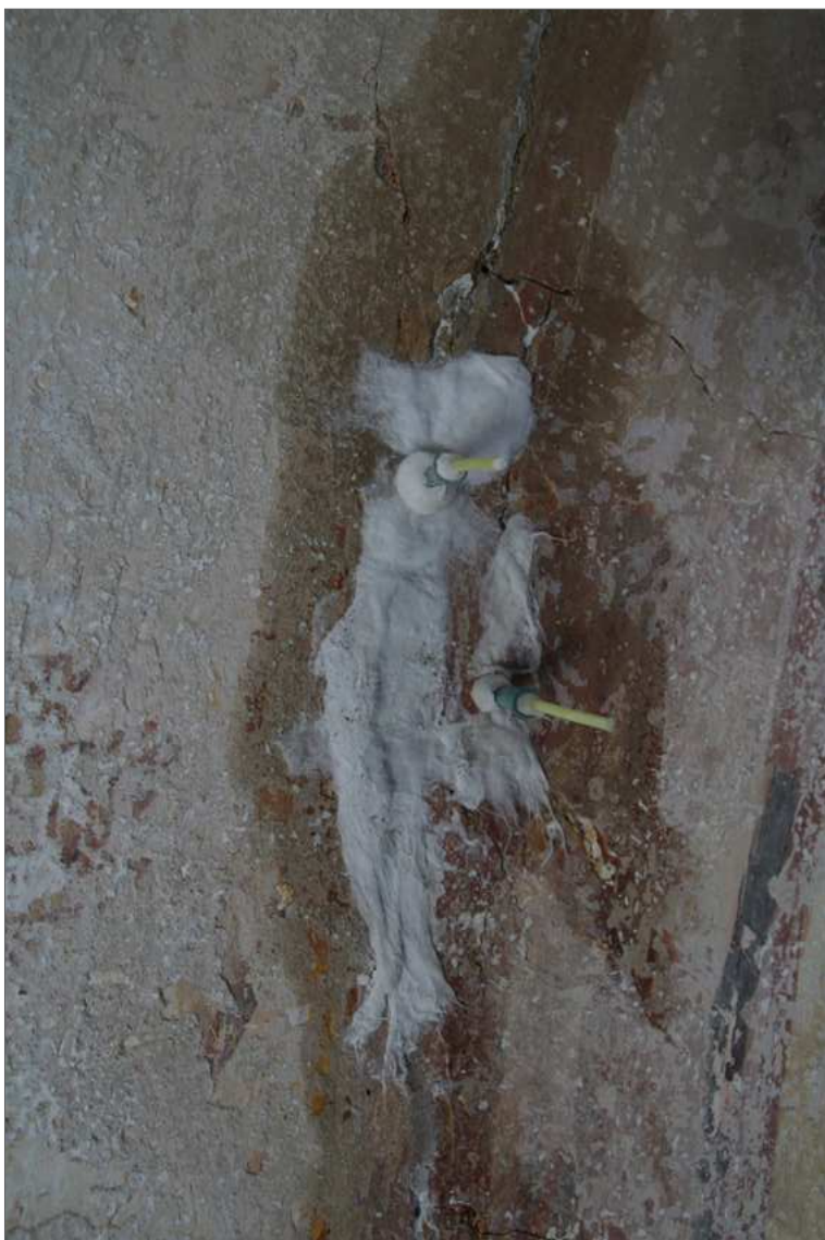
Obr. 66 Proces injektování prasklin směsí Ledanu TA1 s vápencovou moučkou na levé straně v oblasti iluzivní římsy..
