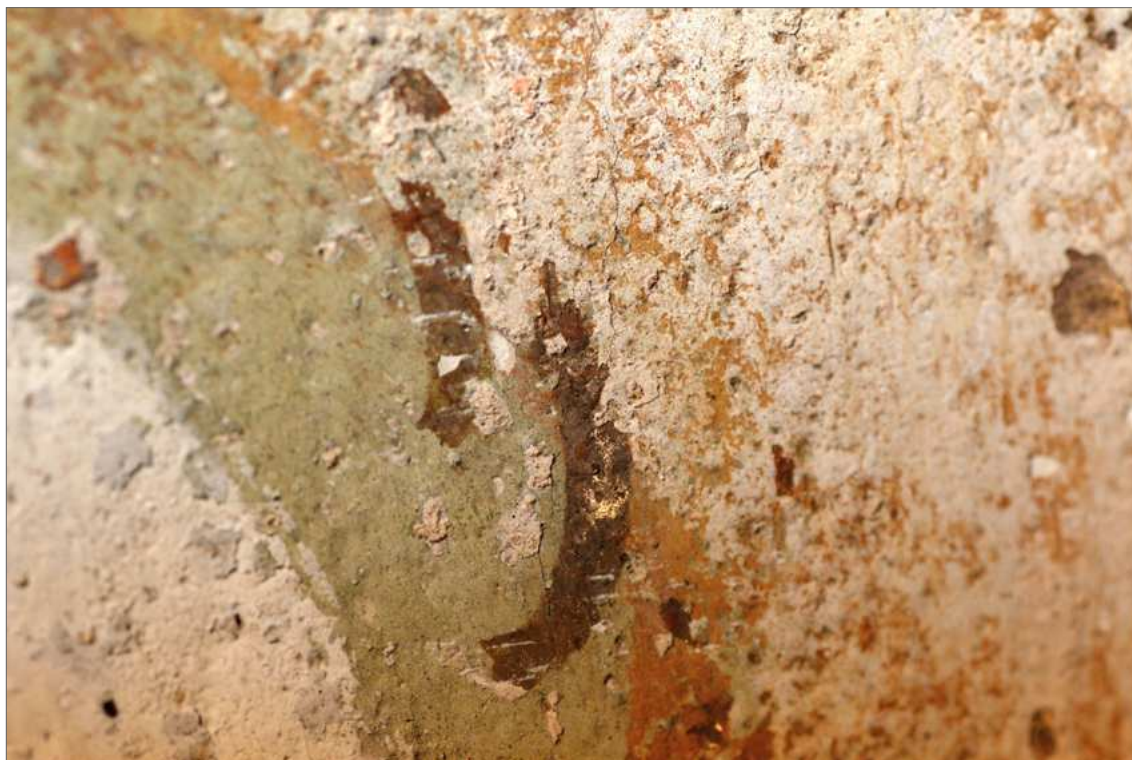
Obr. 28 Detail malby na horní levé straně restaurované stěny, na pravém dekoru vázy. Ztmavlé zlacení a chybějící značná část povrchu okrové barevné vrstvy. Stav po odkryvu.
