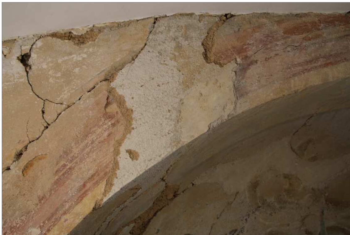
Obr. 32 Druhotné tmely na vrchní části niky a v úseku iluzivní římsy. Tmel s bílou povrchovou úpravou, nachází se i v statické trhlině (nejstarší). Tmel, který je na něm, má jemnozrnný charakter okrovožluté barevnosti a je kletovaný (mladší z roku 1997). Stav po odkryvu.
