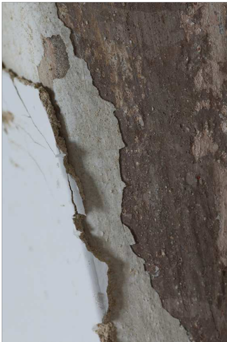
Obr. 62 Detail druhotných vrstev překrývajících restaurované malby. Vrstva štuku a bílého nátěru odstraňovaná při odkryvu. Stav během odkryvu.
