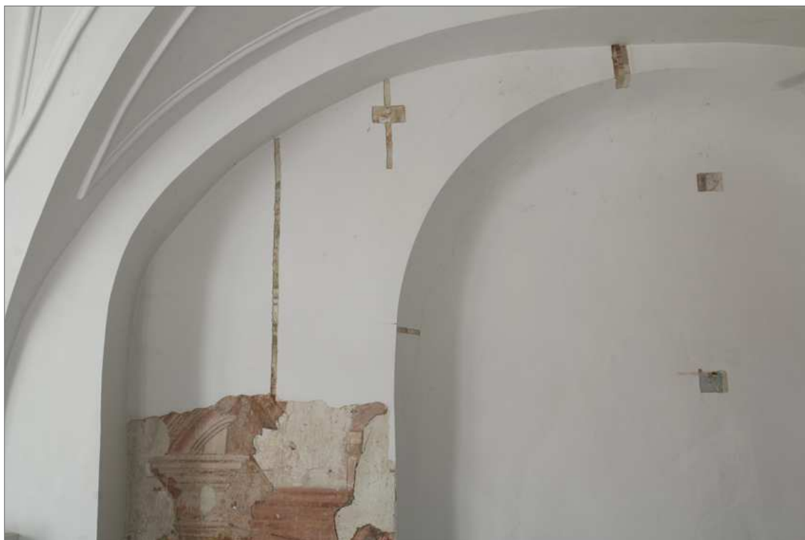
Obr. 16 Levá horní strana restaurované stěny. Stav před odkryvem.
