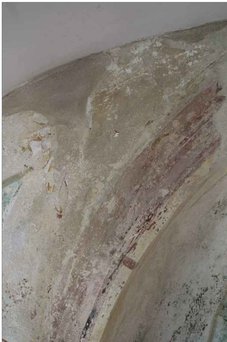
Obr. 72 Horní levá strana restaurované stěny. Na snímku je viditelný okrový zákal na pravé straně od tmelu a na červené římse obíhající kolem niky.
