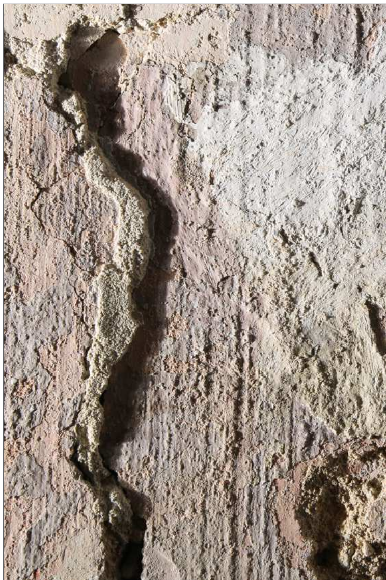
Obr. 37 Detail druhotných tmelů v oblasti šedého pilíře nalevo od hlavy figury. Posun zdiva v okolí praskliny. Stav po odkryvu.
