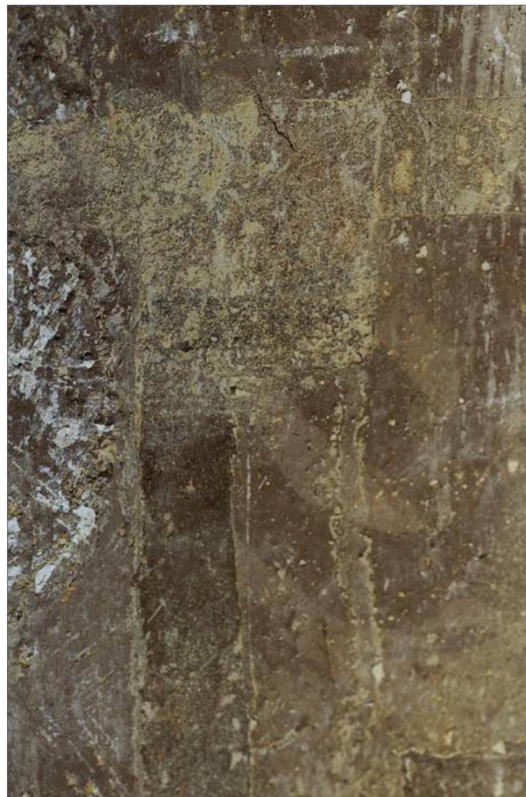
Obr. 34 Detail ze spodní levé části v nice. Rokoková malba. Na snímku jsou viditelné sondy/poškození barevné vrstvy způsobené sondami provedenými při průzkumu v roce 1996. Stav po odkryvu.
