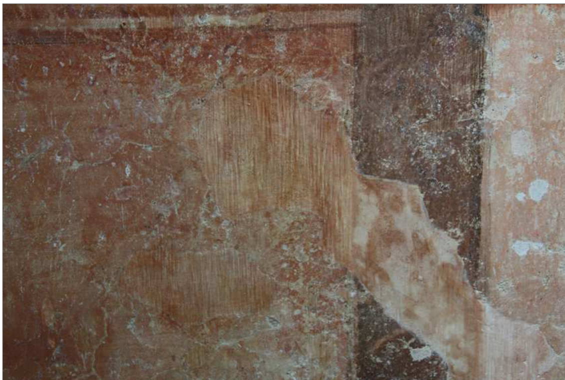
Obr. 80 Detail malby na spodní levé straně restaurované stěny. Čárková retuš na barokní malbě. Stav v průběhu retušování.
