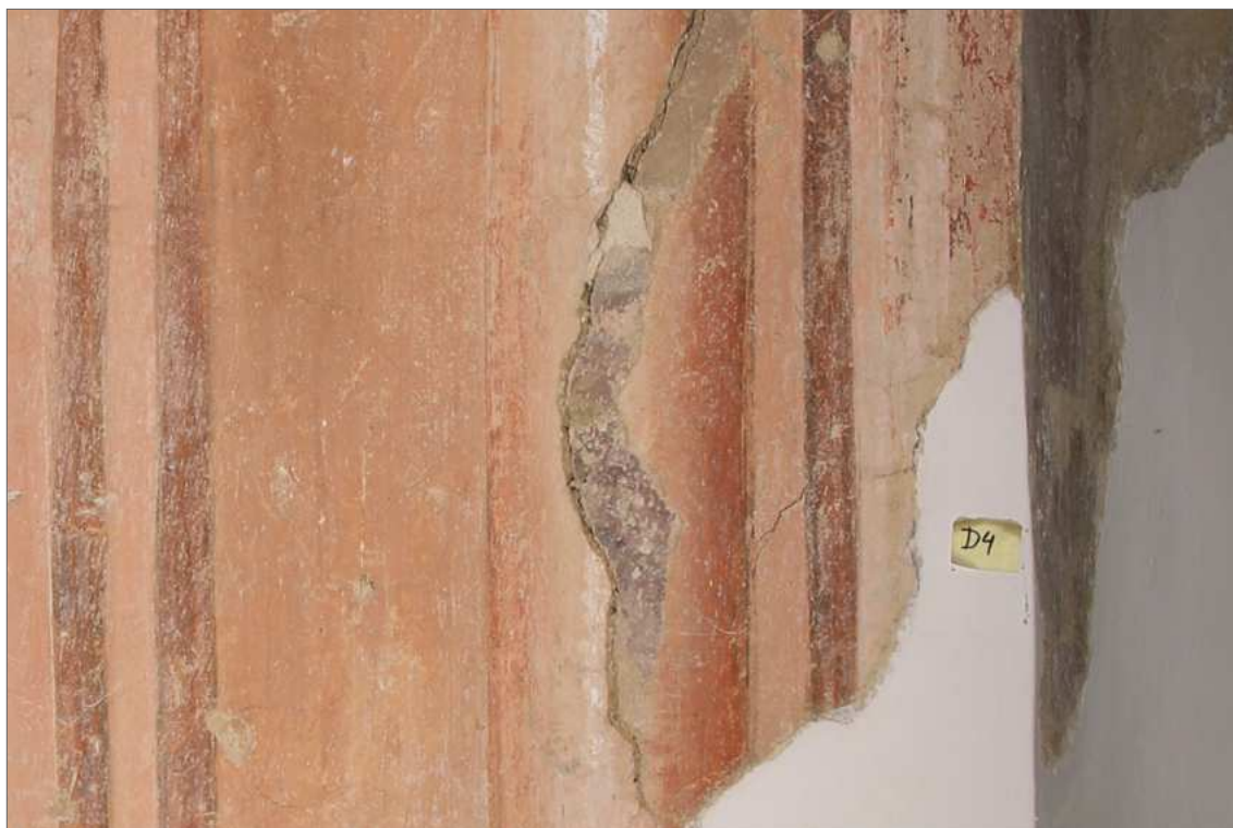
Obr. 31 Druhotný tmel s hrubou povrchovou strukturou nacházející se ve statické trhlině. Předpokládáme, že je nejstarším z tmelů a je z doby před rokokem. Stav po odkryvu.
