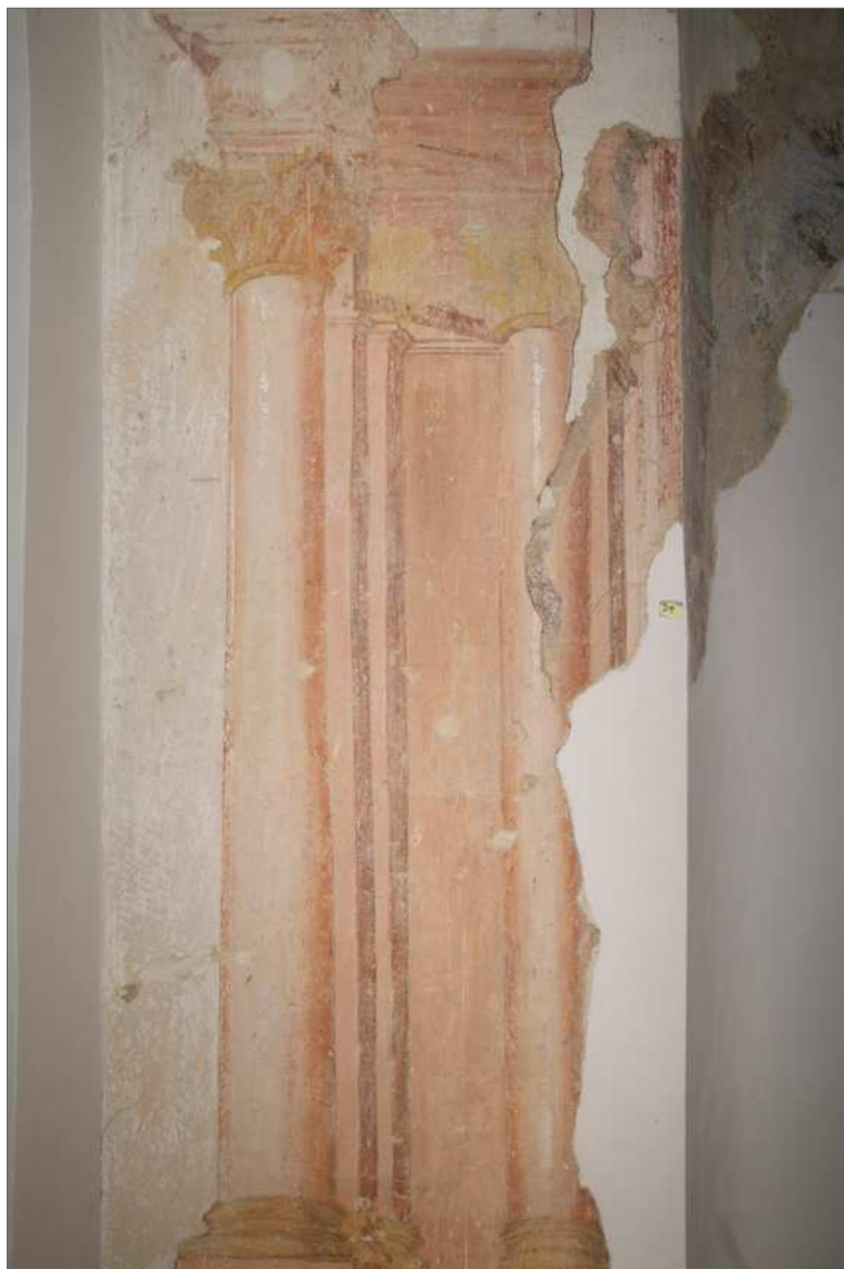
Obr. 39 Střední část levé restaurované stěny. Vizuální průzkum v rozptýleném denním světle. Stav po odkryvu.
