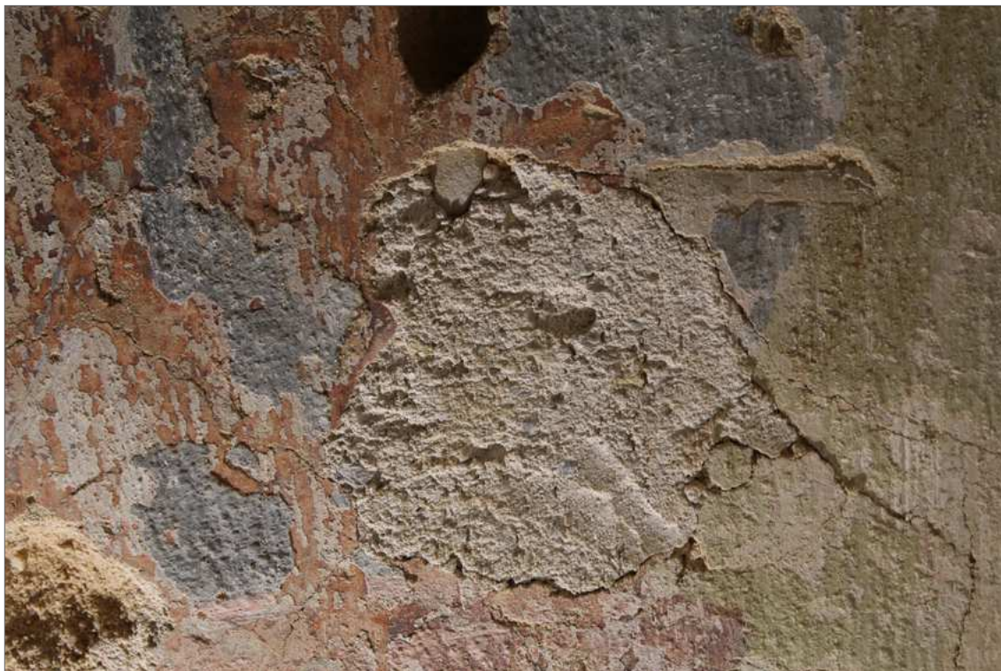
Obr. 29 Detail malby v oblasti dolní části restaurovaného úseku. Druhotný světle šedý, tvrdý tmel s velmi hrubozrnnou strukturou cementového charakteru, nedatovaný. Stav po odkryvu.
