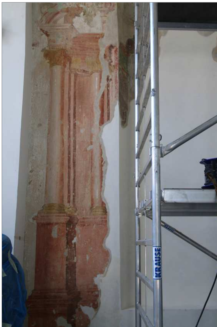
Obr. 95 Barokní etapa výmalby na levé straně stěny, střední část. Stav po tmelení.
