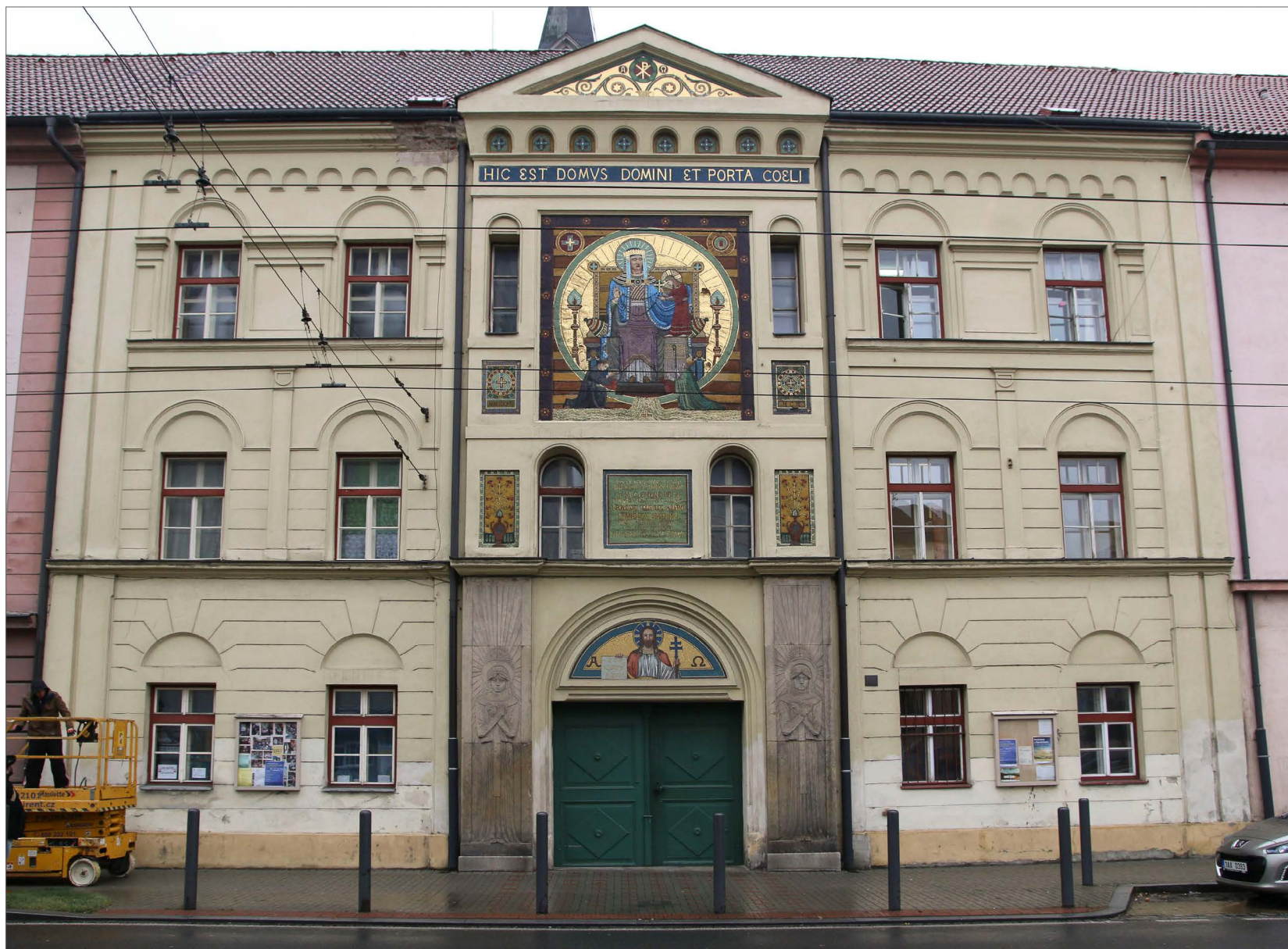
Obr.04: Stav před restaurováním – celkový pohled na čelní fasádu s mozaikou v ulici Žižkova třída 512.
