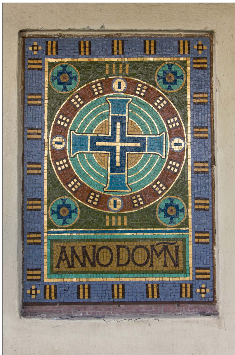
Obr.08: Stav před restaurováním – levý výjev s řeckým křížem a nápisem ANNODOMINI.
