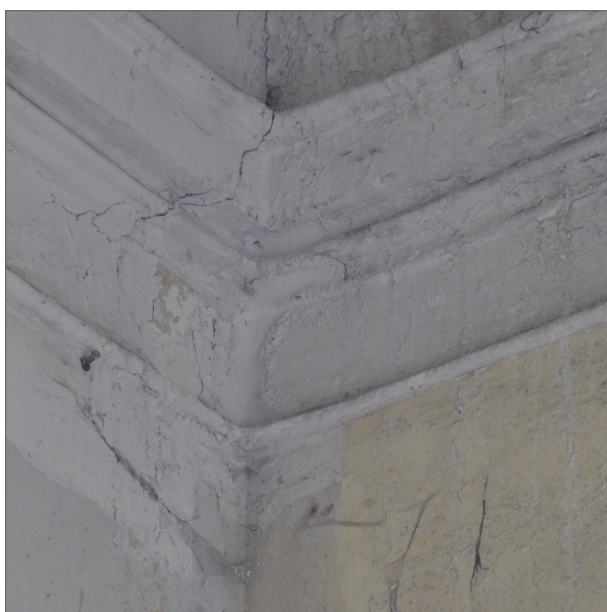
Obr.14 Jídelna - Detail poškození zatékáním v jihozápadním rohu místnosti, nároží je dále poškozeno trhlinou
