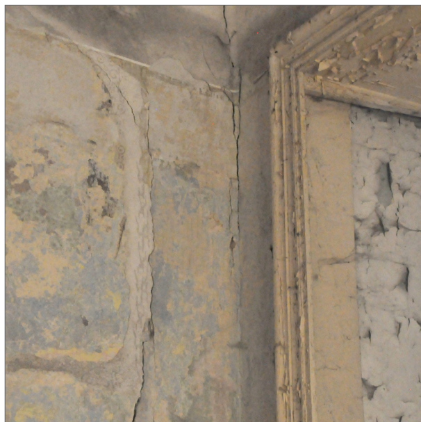
Obr.24 Renesanční - Severovýchodní nároží místnosti je poškozeno trhlinami, které dále probíhají po obvodu dveří
