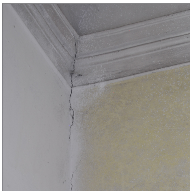
Obr.13 Jídelna - Detail poškození severozápadního rohu trhlinou, bílé stříkance pocházejí s největší pravděpodobností z mladší opravy ve dvacátém století.
