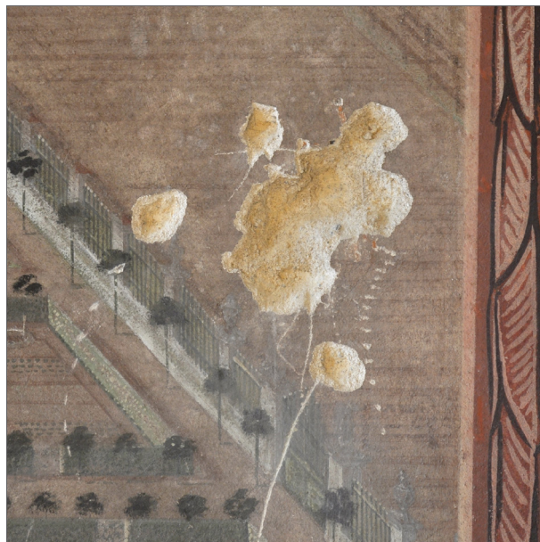
Obr.17 Veduty - Detail poškození barevné a omítkové vrstvy na pravé straně jižní veduty způsobené otlučením
