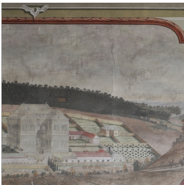
Obr.18 Veduta severní stěny - patrné poškození malby stékanci nacházejícími se především v oblasti oblohy
