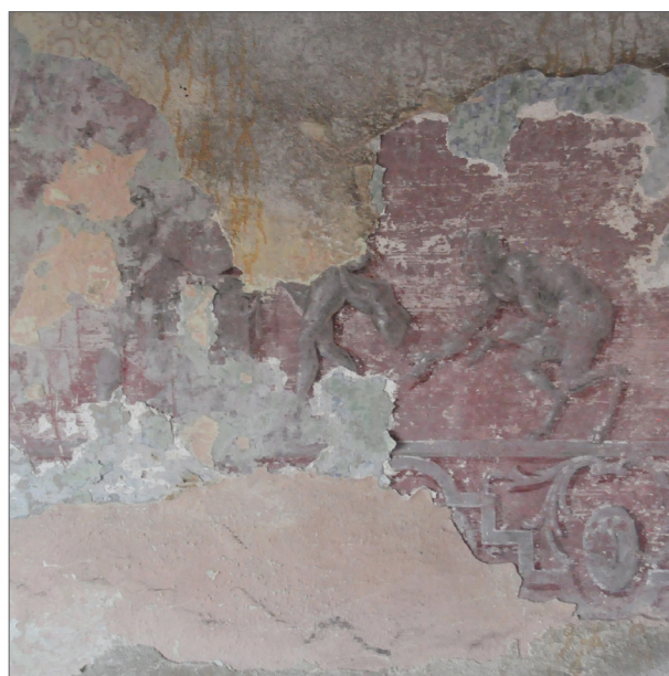
Obr.26 Renesanční - Detail figurálního výjevu na supraportě severní stěny. Barevná vrstva je částečně poškozena odkryvem.
