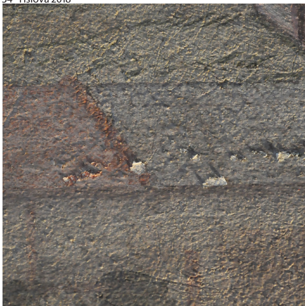
Obr.20 Veduty - Detail odlupující se barevné vrstvy na výjevu způsobené stěkancí
