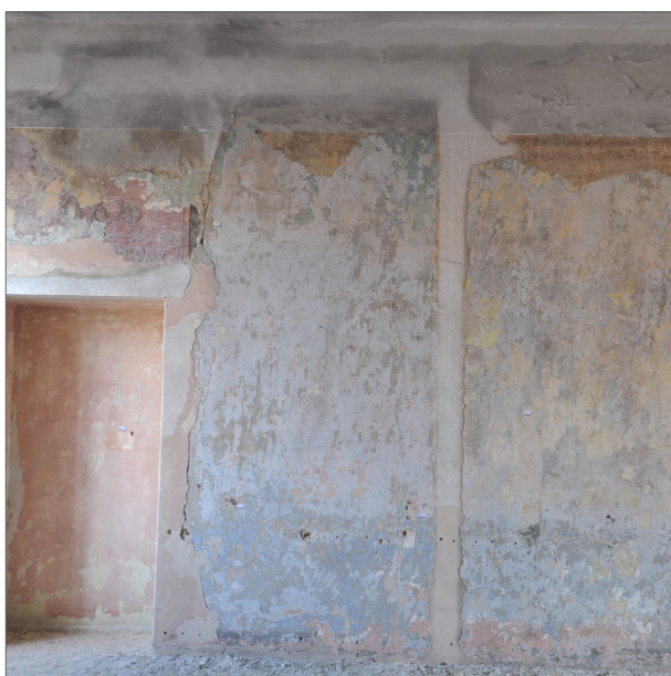
Obr.25 Renesanční - Jižní stěna místnosti - na levé straně se nachází zazděný dveřní průchod. Celá stěna je pokryta fragmenty různých etap barevného provedení. V levé horní části se nachází ztmavlé oblasti způsobené zatékáním. Na stěnách se také nachází poškození elektroinstalacemi
