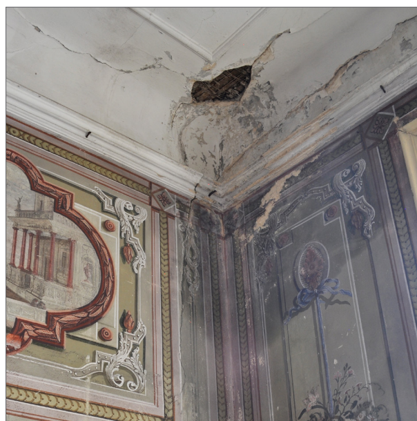
Obr. 16 Veduty - Poškození v severovýchodním rohu místnosti - zatékání do zdiva způsobené poškozenou krytinou zámku. Tmavé oblasti ukazují zvlhčení zdiva v dané oblasti. Kromě zatékání se v nároží nacházejí také trhliny
