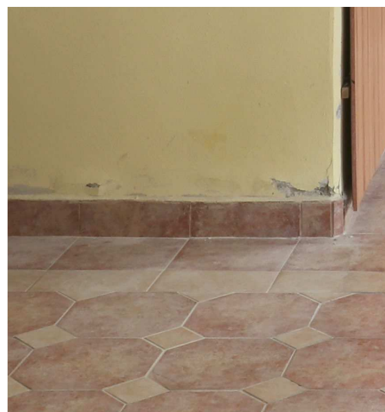
Obr.07 Poškození barevné vrstvy ve spodní části severozápadní stěny.
