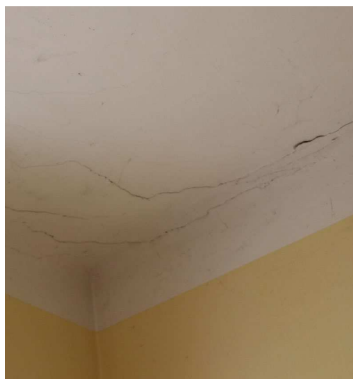
Obr.08 Trhlinka procházející celým obvodem fabionu a jeho okolím.
