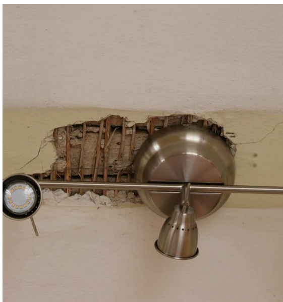
Obr.06 Chybějící omítkové vrstvy pod osvětlením v východní části kaple.
