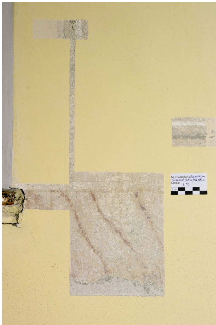
Sonda S10: Celkový pohled na sondu. Na sondě je patrné mramorování soklové části zdi. Při spodním okraji sondy se nachází hranice omítkové opravy soklových partií po roce 2002.
