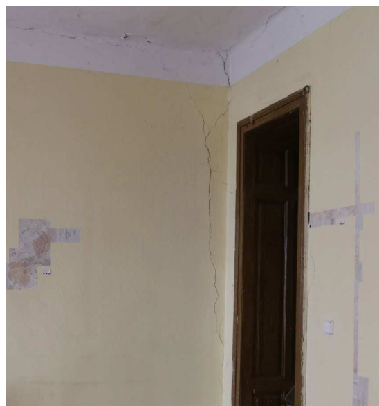
Obr.03 Trhlina procházející celou výškou zdi a fabionem v západním koutu kaple.
