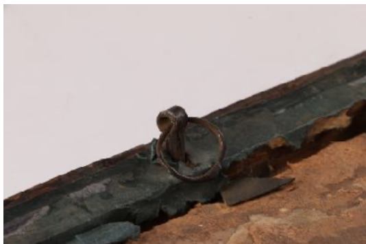
Obr. 1.5: Stav před restaurováním, detail závěsného systému.
