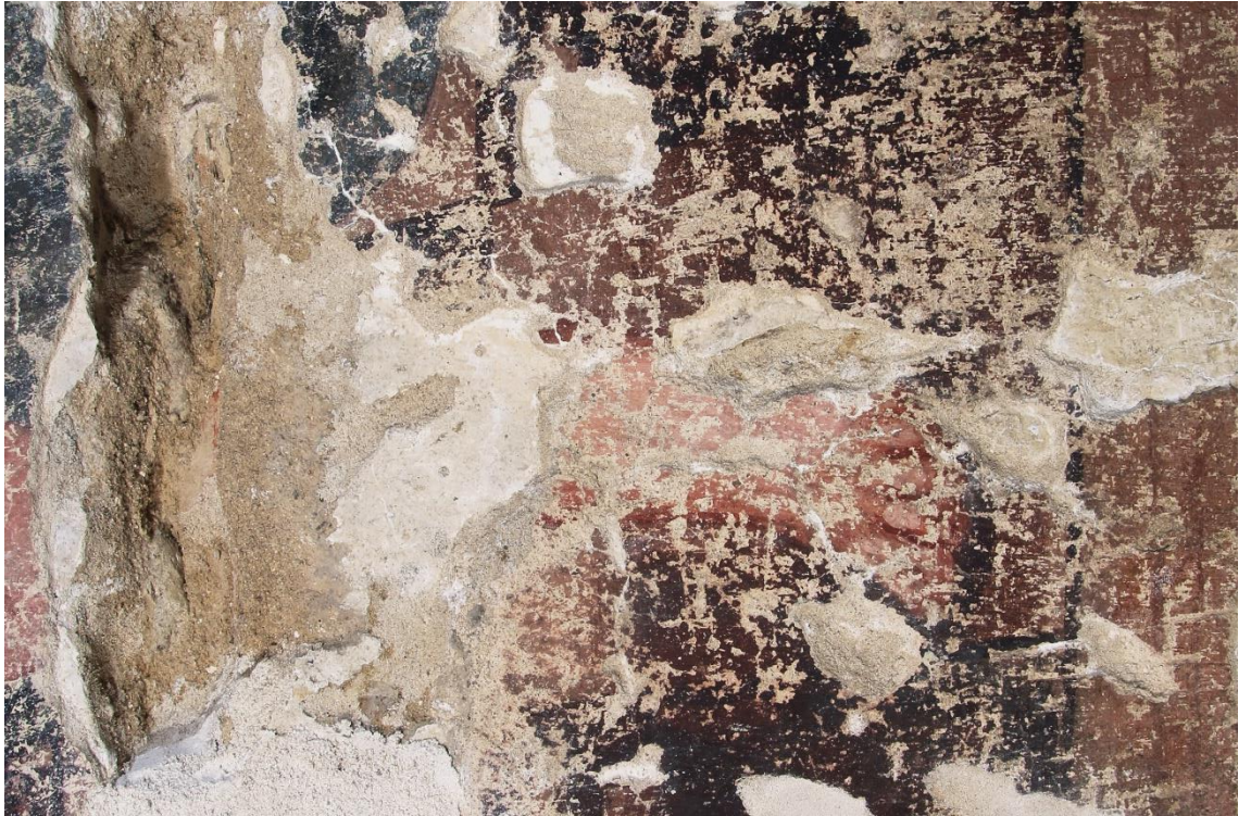
Obr. 72 Sekvence detailu poškozeného chodidla. Stav po čištění.
