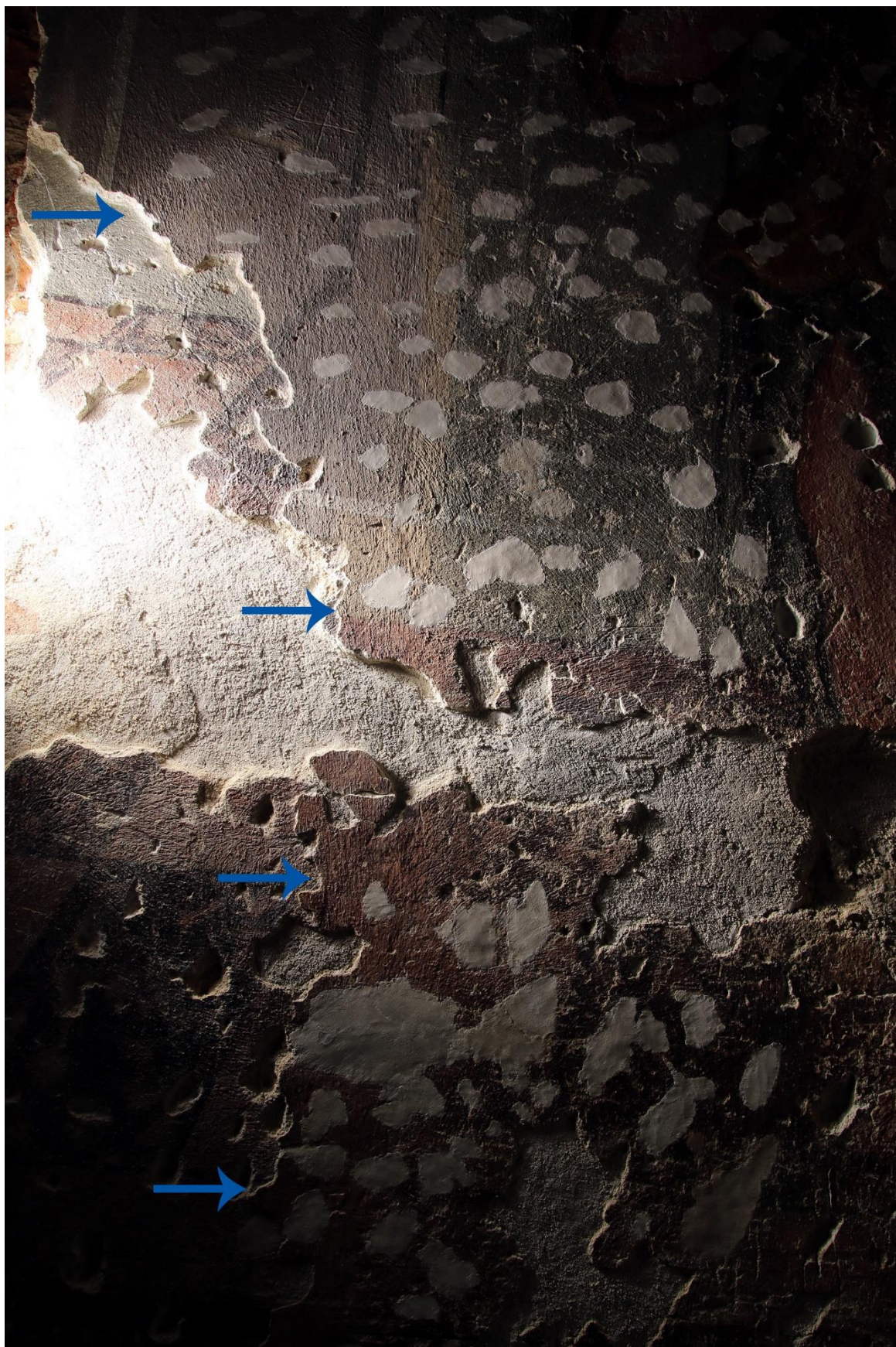
Obr. 39 Detail malby v ostrém bočním nasvícení, viditelné vrstvení původní omítky a dorovnávací vrstvy. Stav v průběhu tmelení.
