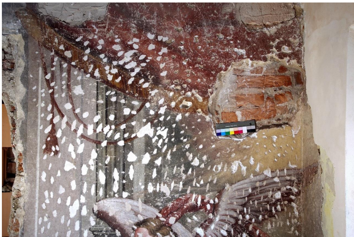
Obr. 49 Detail horní části díla, stav po čištění a dozdění největších hloubkových defektů.
