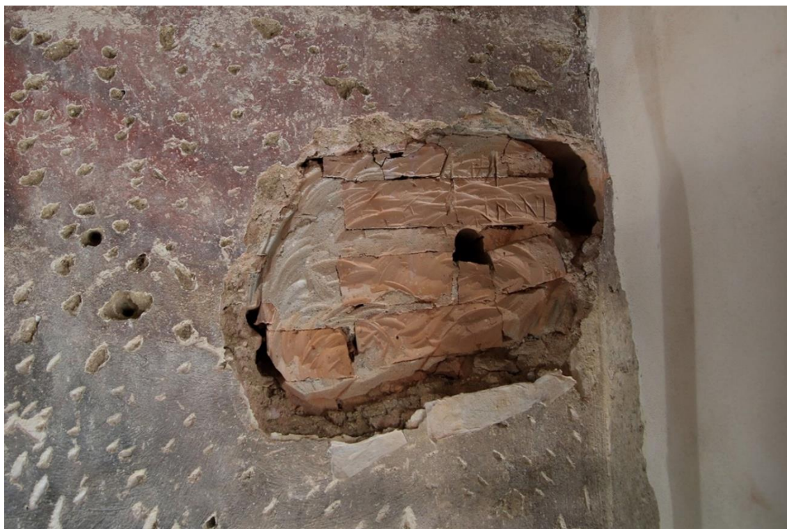
Obr. 68 Sekvence oblasti defektu po instalaci topení. Stav po odkryvu a odstranění druhotných vysprávek.
