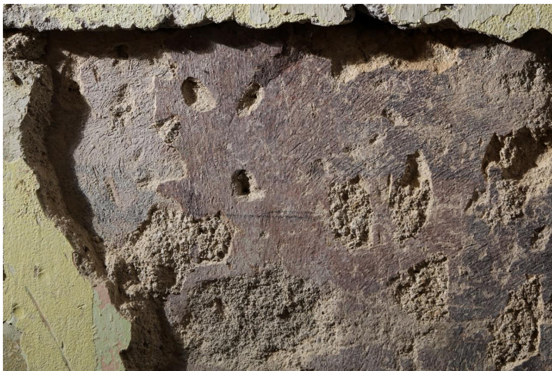
Obr. 24 Detail v oblasti pod druhotným tmelem v ostrém bočním nasvícení, nález grafitové linky. Rovněž lze vidět rozhraní chybějící dorovnávací omítky. Stav před restaurováním.
