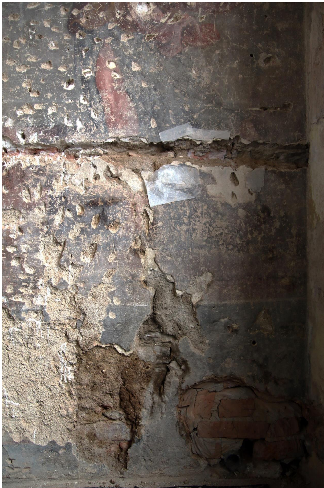
Obr. 42 Dolní část restaurovaného úseku. Na fotografii lze pozorovat „mokrý“ efekt nejspíše způsobený vodorozpustnými solemi a bílý nátěr na historické omítce. Stav po odkryvu a provedení zajišťujících přelepů.
