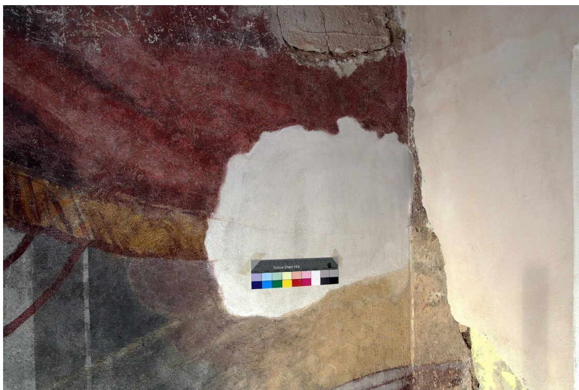
Obr. 71 Sekvence oblasti defektu po instalaci topení. Stav po restaurování.
