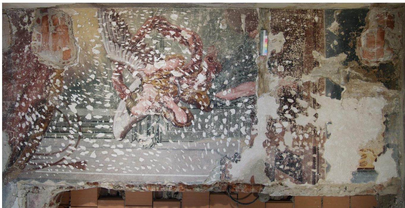
Obr. 65 Sekvence celkového úseku. Stav před restaurováním.
