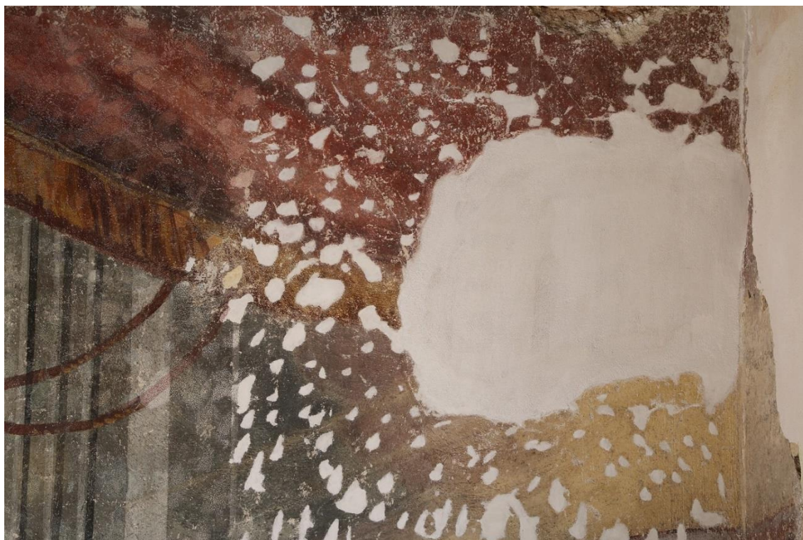
Obr. 70 Sekvence oblasti defektu po instalaci topení. Stav po tmelení.
