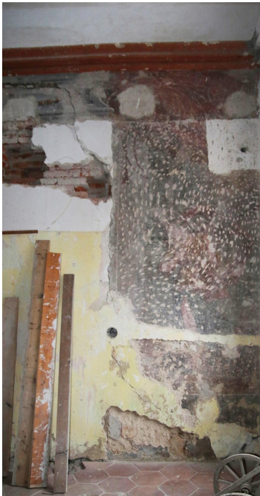
Obr. 16 Restaurovaný úsek na jižní stěně v místnosti před zámeckou kaplí. Stav před částečným vybouráním průchodu. Autor fotografie: Zuzana Wichterlová.
