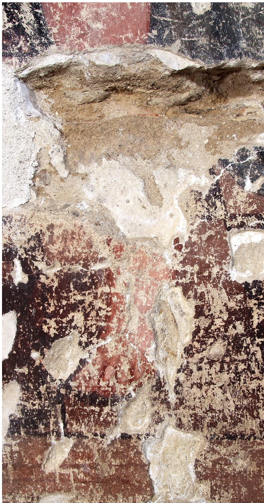
Obr. 48 Detail poškozeného chodila figury archanděla Gabriela. Stav po čištění.
