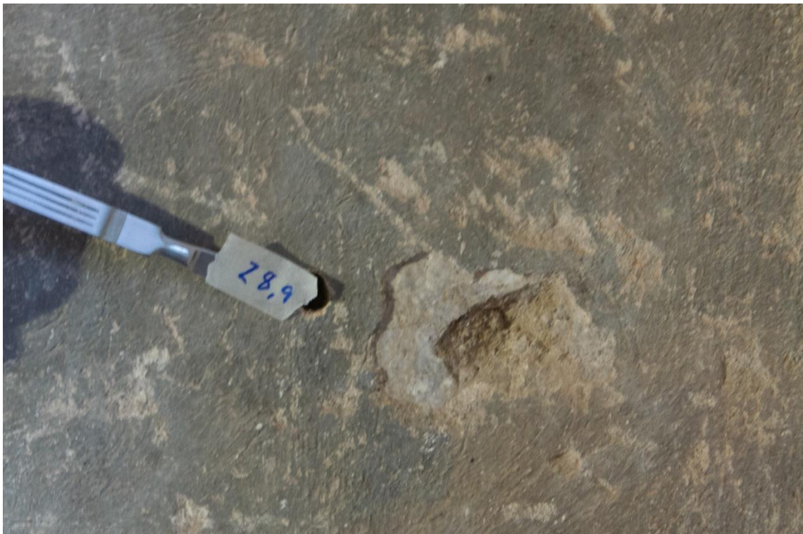
Obr. 43 Lokalizace odběru vzorků ke stanovení obsahů vodorozpustných solí Z8, Z9, detail.
