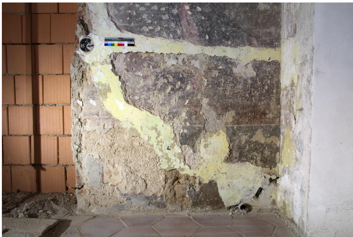
Obr. 18 Soklová část, nasvícená bočním světlem. Stav před restaurováním.
