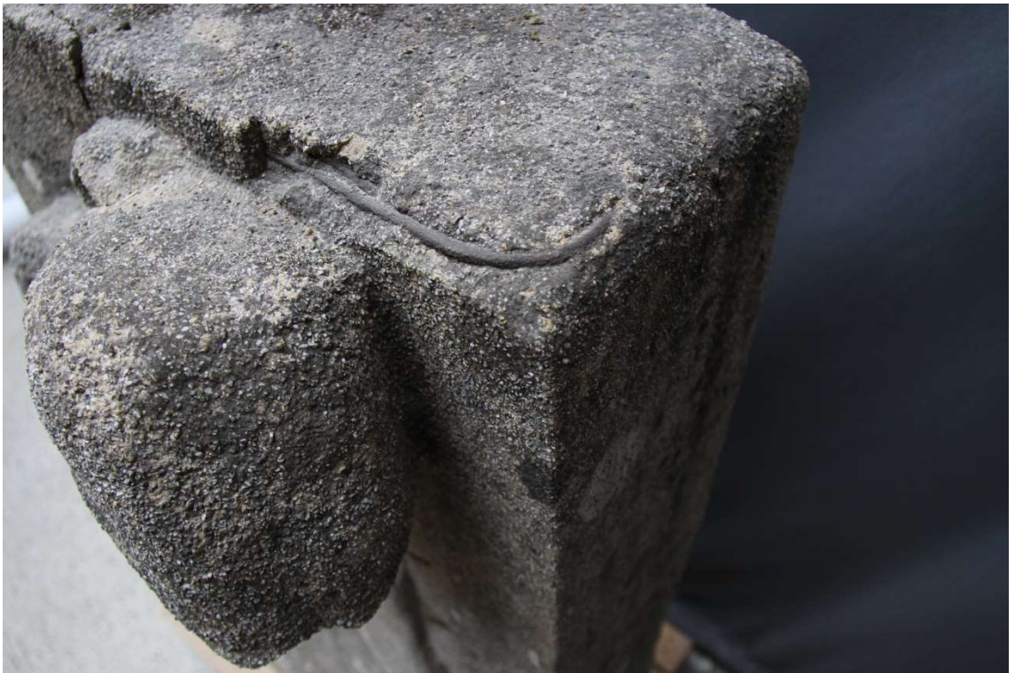
Obr. 14 Stav před restaurováním, detail obnažené armatury, pohled ze shora
