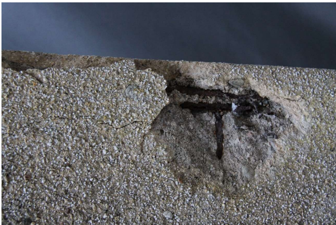
Obr. 19 Stav před restaurováním, detail zkorodované armatury, zadní strana
