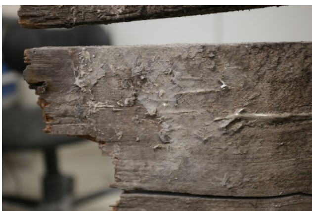
Obr. č. 42 Uvolněné trnože a další výztuže díla. (Vpravo detail). Těž podléhají hnilobě a jsou napadena mikrobiologickým povlakem. Detail mikrobiologického napadení ve spodní části dřevěné konstrukce (stojná deska). Postupně se ve dřevě tvoří příčné a podélné trhliny, které zapříčiňují rozsáhlý kostkový rozklad a tak totální rozpad dřeva. Fotografie pořízeny 16.11.2022
