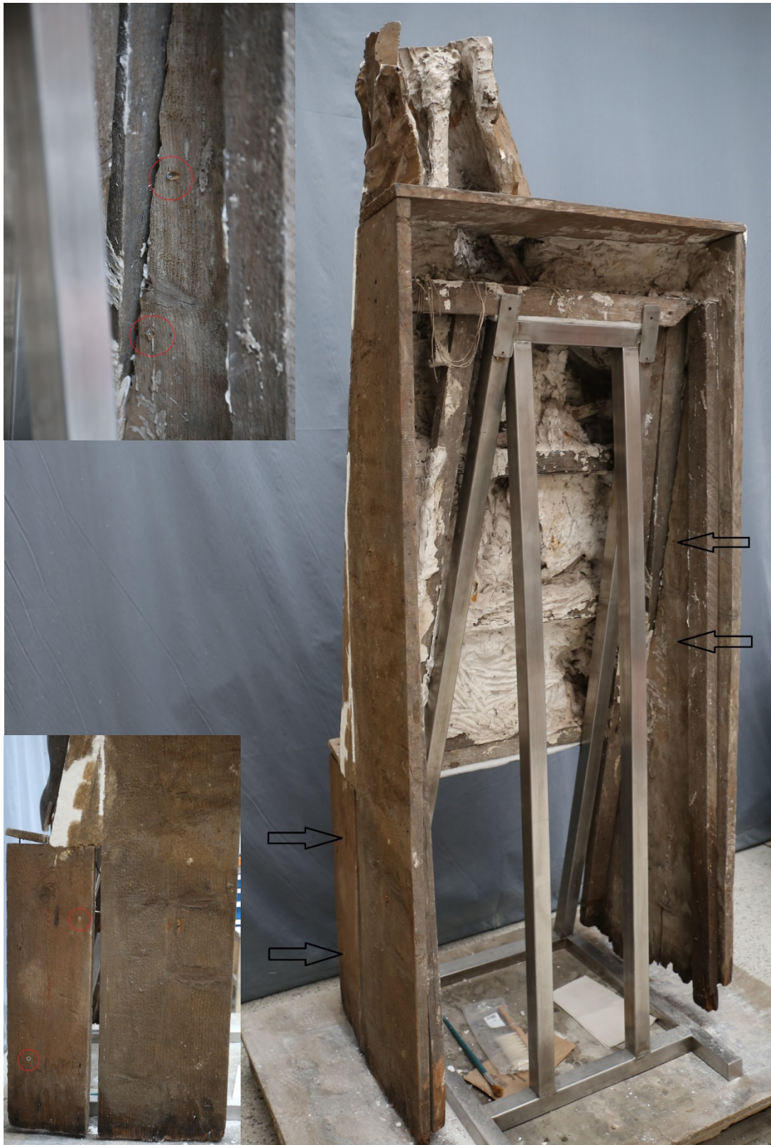
Obr. č. 56 Grafické znázornění umístění nerezových vrtů s podložkami na díle. Stabilizována byla volně visící prkna do konstrukčních latí. Fotografie pořízeny 26.1.2023
