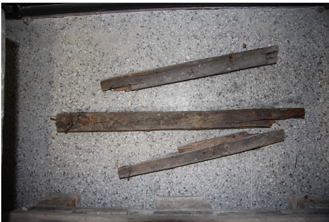
Obr. č. 40 Konstrukce se nachází ve špatném stavu, mnoho trnůží a hranolových výztuží z rubové strany konstrukce je uvolněno. Fotografie pořízena 16.11.2022
