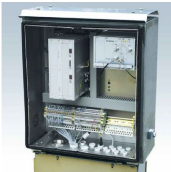
Obrázek 3 Traťová elektrická jednotka LEU
