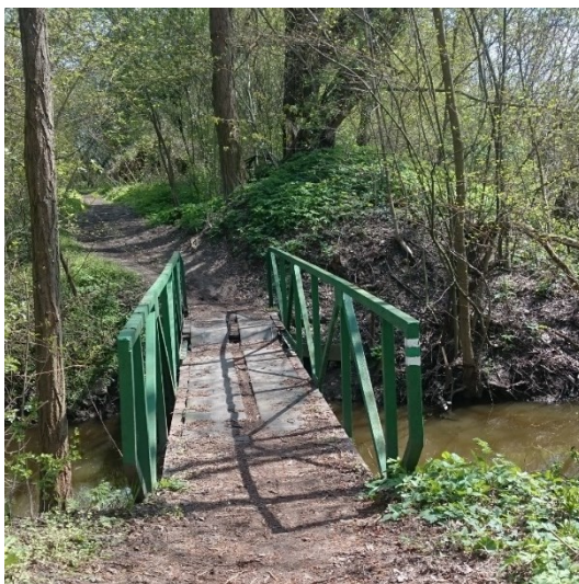
Obrázek 20 Nesjízdňý povrch – lávka přes slepé rameno Piloty (autorka)
