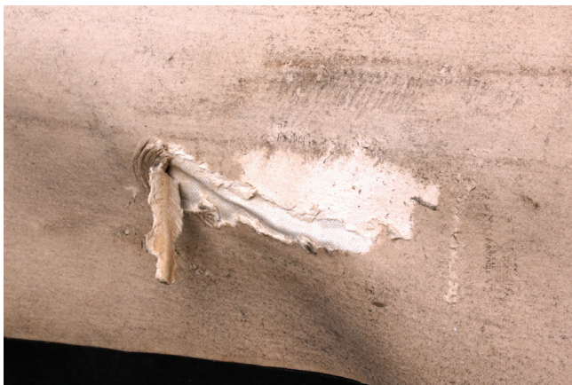
Obr. 3 Detail mechanického poškození / Detail of mechanical damage
