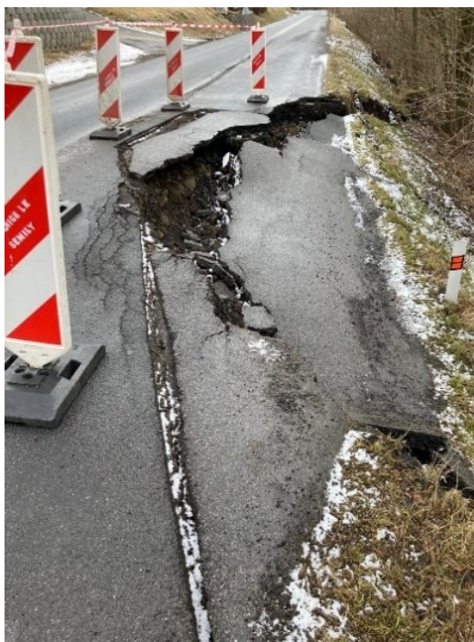
Obrázek 15 - Zřícená část vozovky
