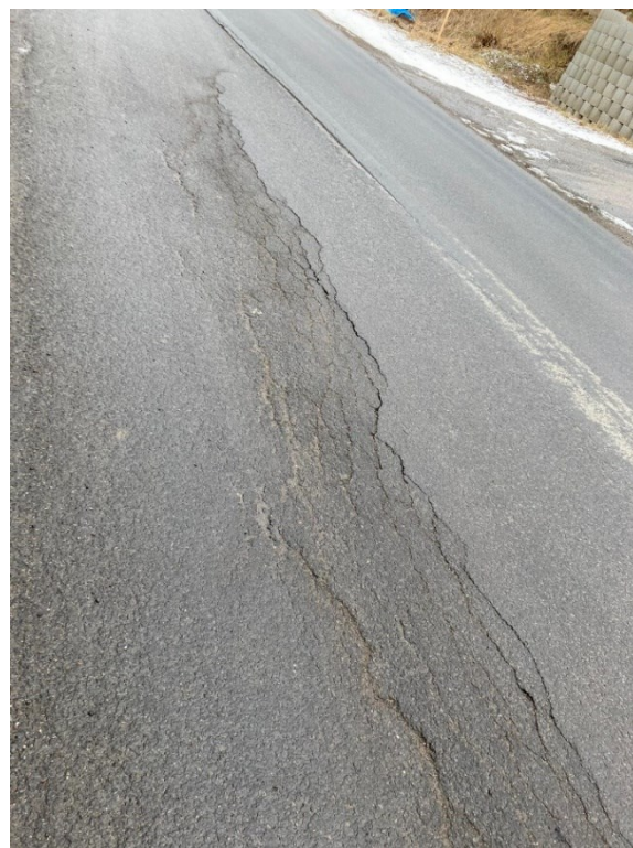
Trhlina rozvětvená podélná
