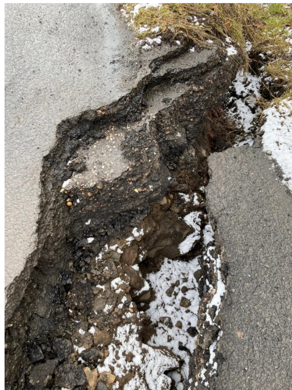
Detail odtržení části konstrukce
