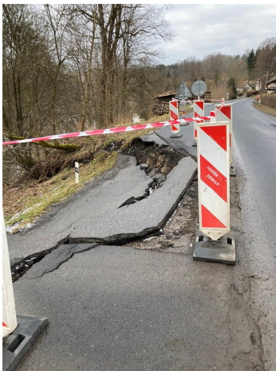
Pohled na sesuv ve směru Loukov
