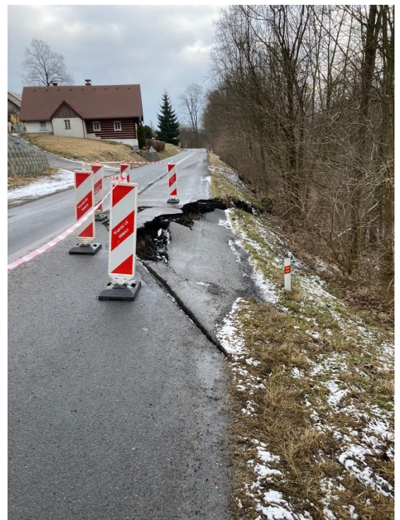
Pohled na sesuv ve směru Horní Sytová
