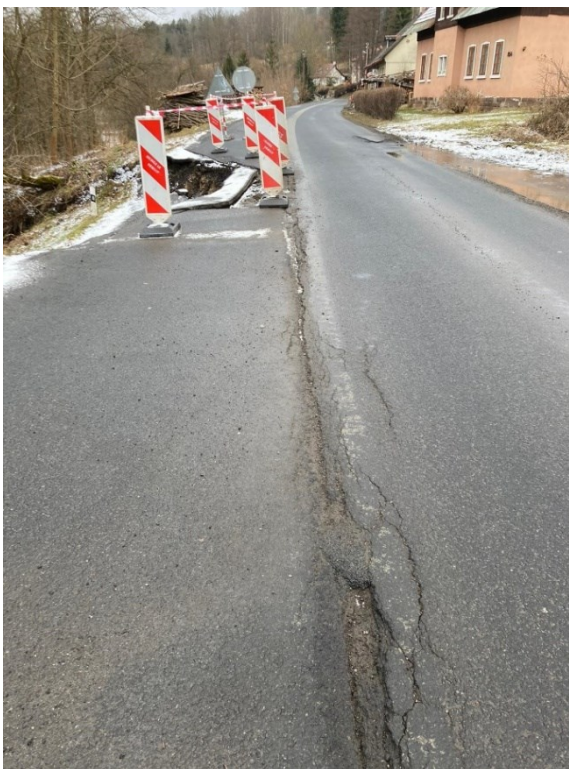
Trhlina široká podélná
