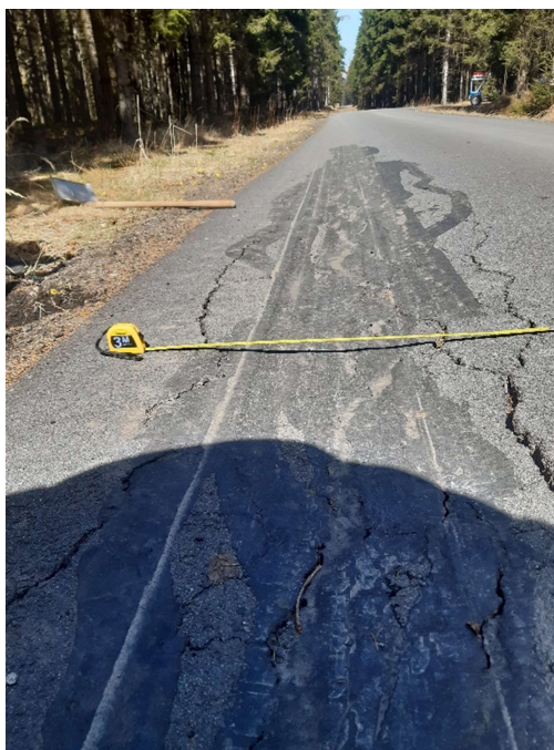
Obrázek 46 Fotografie poškození povrchu úseku č. 6 (zdroj: vlastní fotografie)
