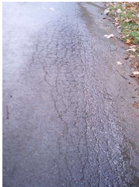
Obrázek 5 Ukázka důsledků zatěžování – síťové trhliny na vozovce se stmelěným povrchem (zdroj: vlastní fotografie)
