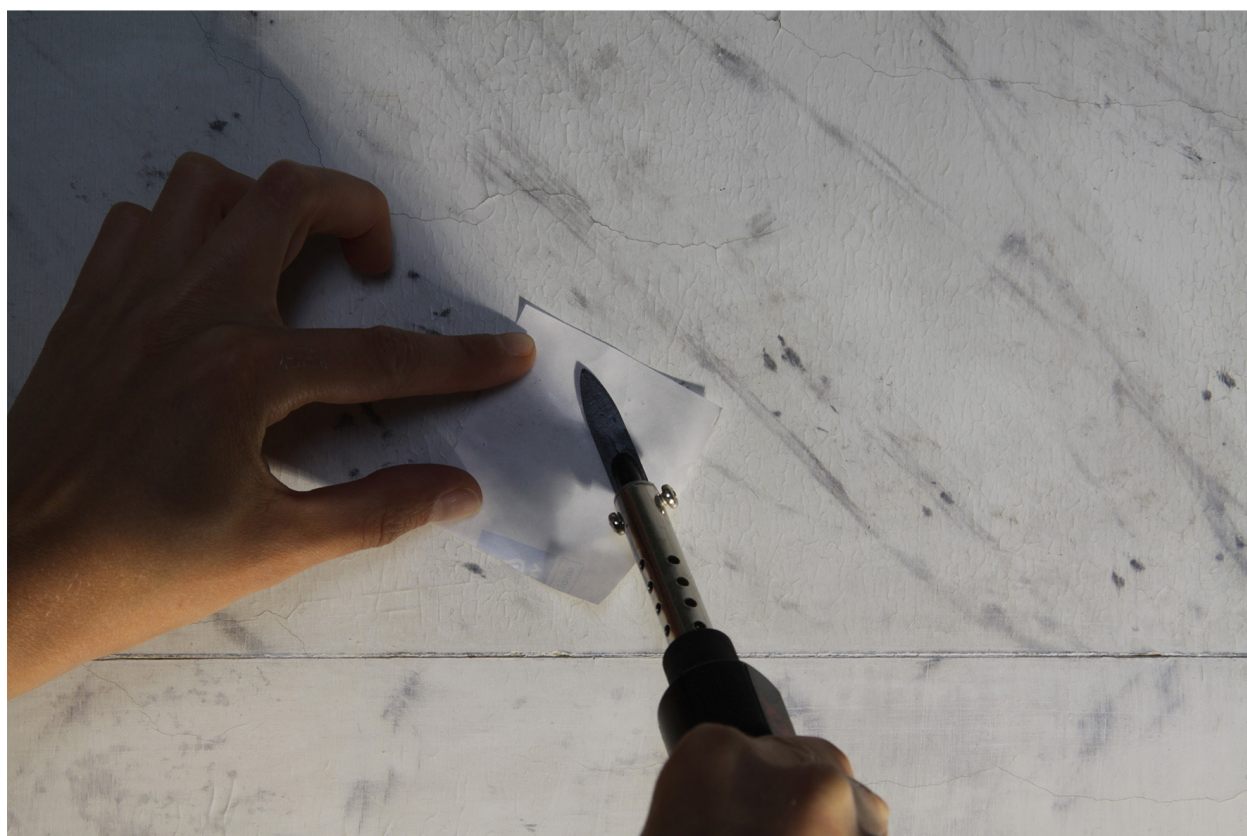
Obr. 28: Ukázka postupu konsolidace šupin barevné vrstvy – přitisknutí šupin k podkladu pomocí vatového tamponu v mikrotenové folii. Severní okenní špaleta východní stěny.
