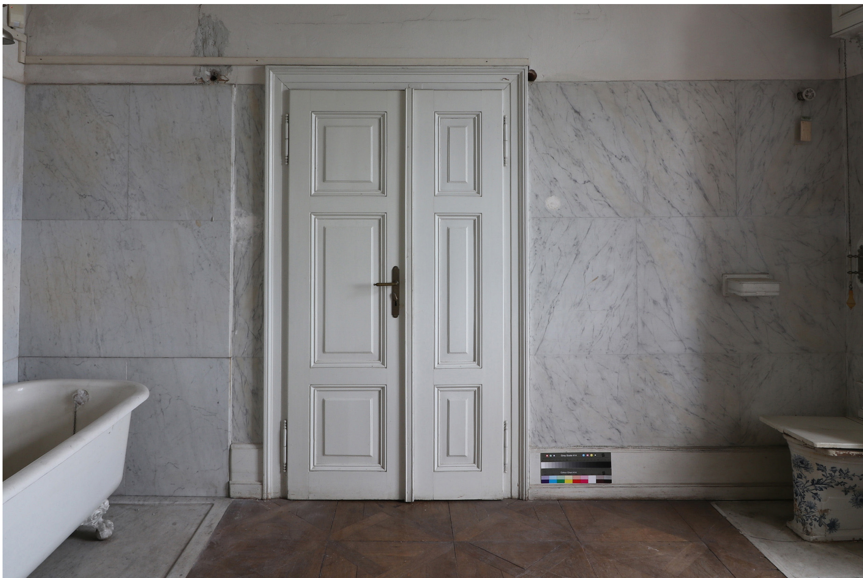
Obr. 04: Pohled na severní stěnu místnosti č. 106. Stav před restaurováním.
