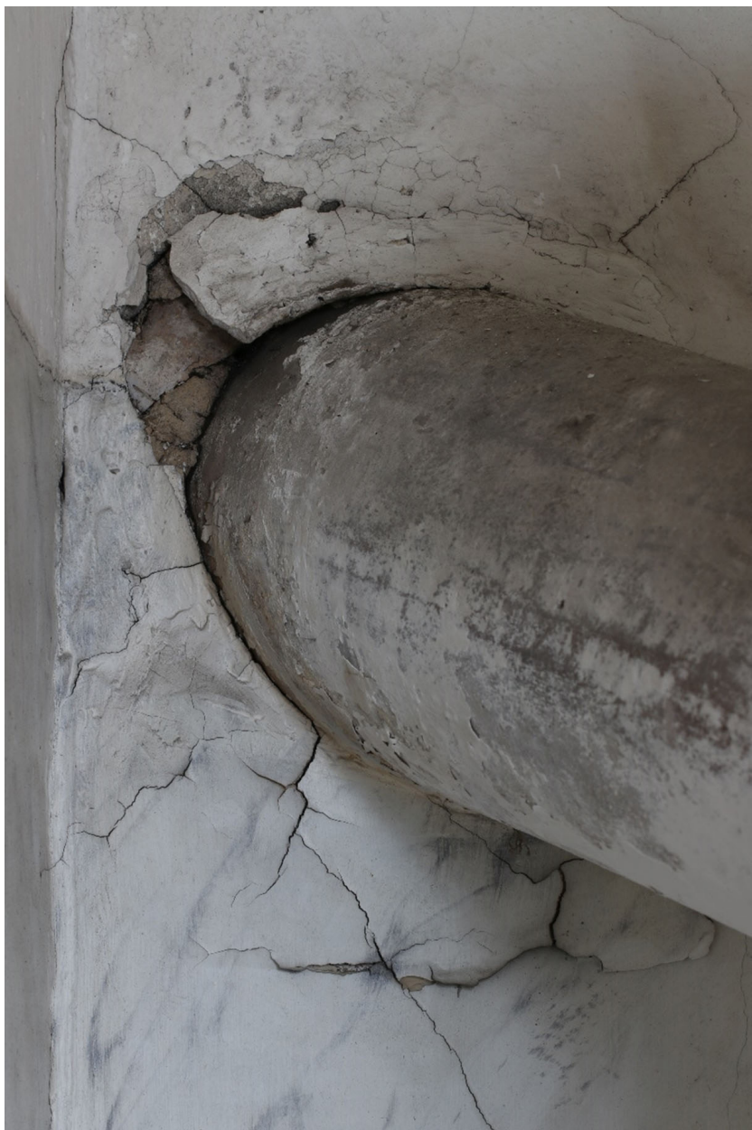
Obr. 18: Ukázka narušené stability omítkových ker v oblasti kolem kouřovodu. Jižní část západní stěny. Stav před restaurováním
