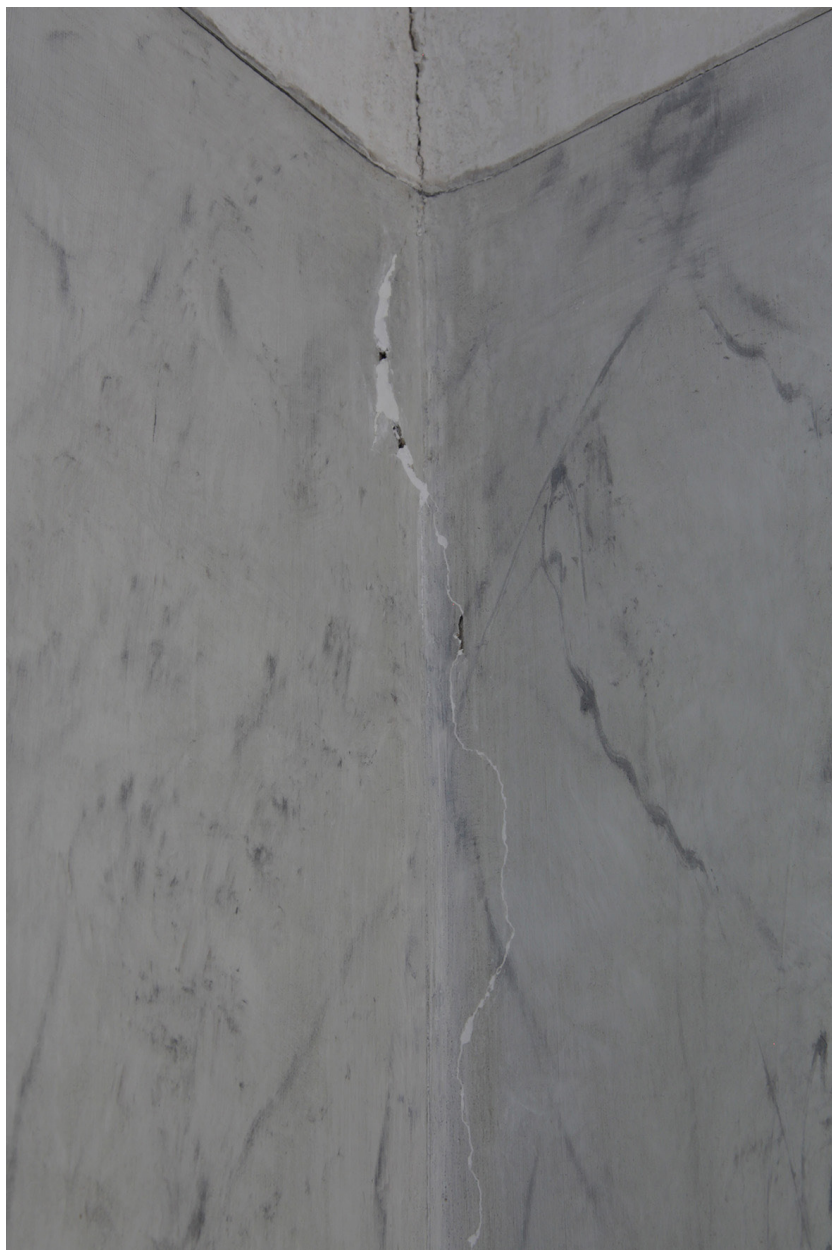
Obr. 32: Ukázka tmelení prasklin v jihovýchodním koutě. Stav před injektáží.
