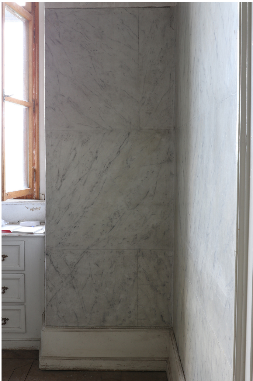
Obr. 07: Pohled na jižní část východní stěny. Stav před restaurováním.
