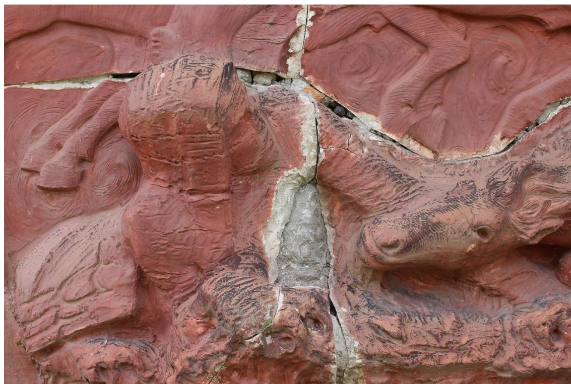
Obrázek 27: Detail ležící figury, stav po očištění a odstranění dožilých spár a tmelů.
