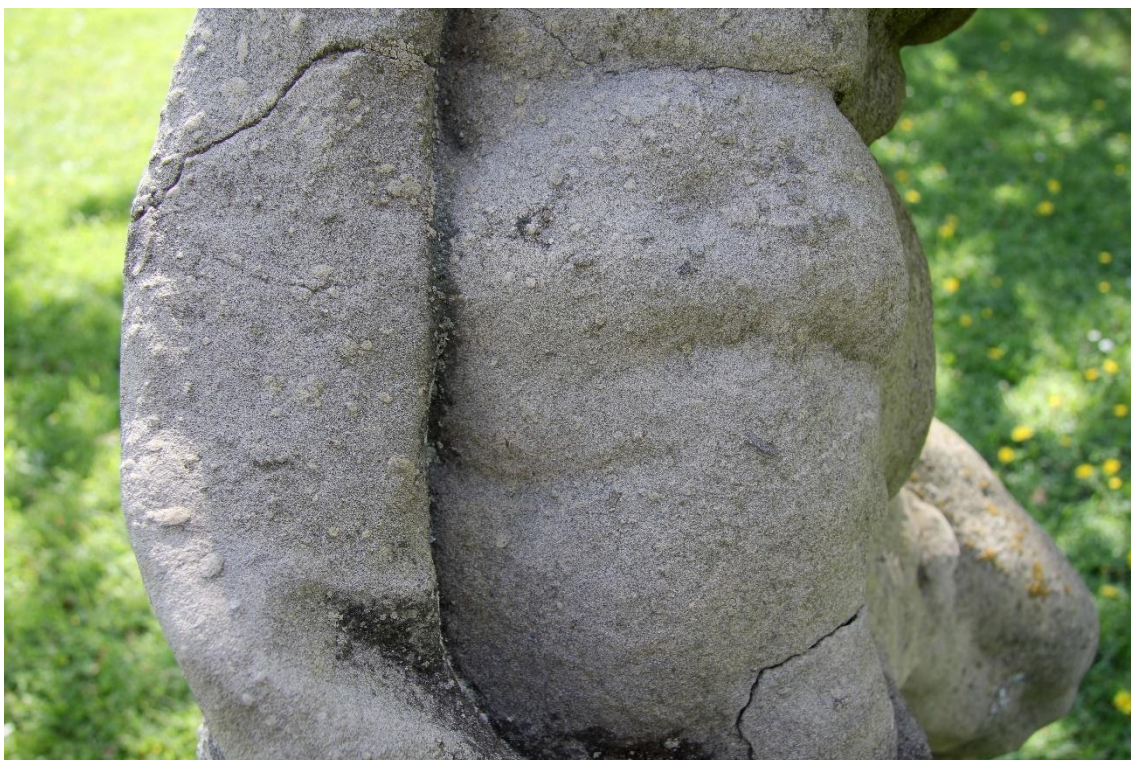
obr. 17 Závalky špatně rozmíchané epoxidové pryskyřice, praskliny – faksimile umělého kamene pojeného epoxidovou pryskyřicí
