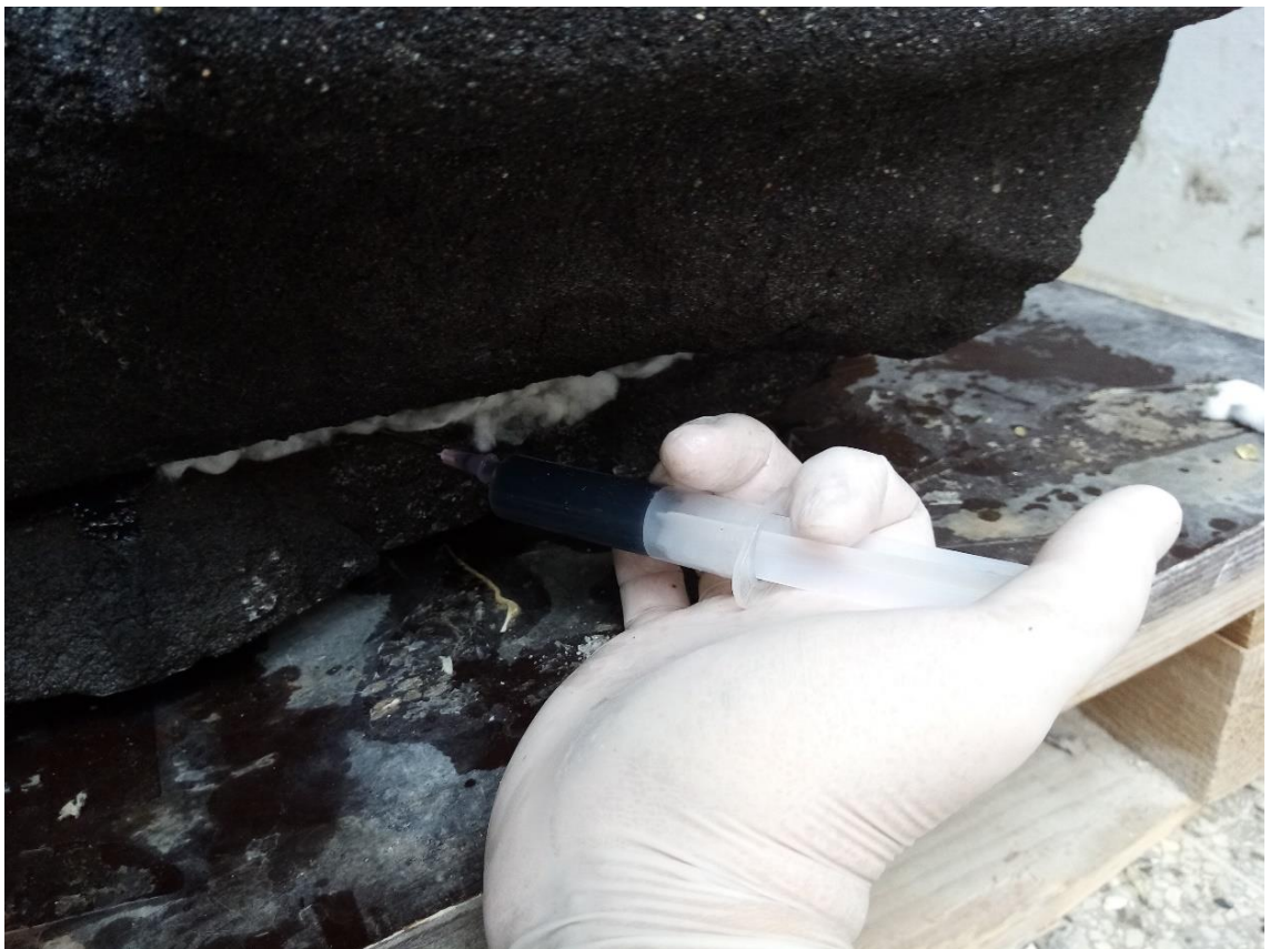
obr. 106 Detail injektáže praskliny spodní část faksimile
