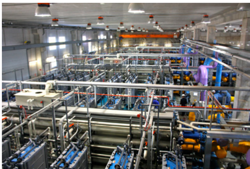
Obrázek 8: Největší odsolovací stanice využívající EDR [25]
