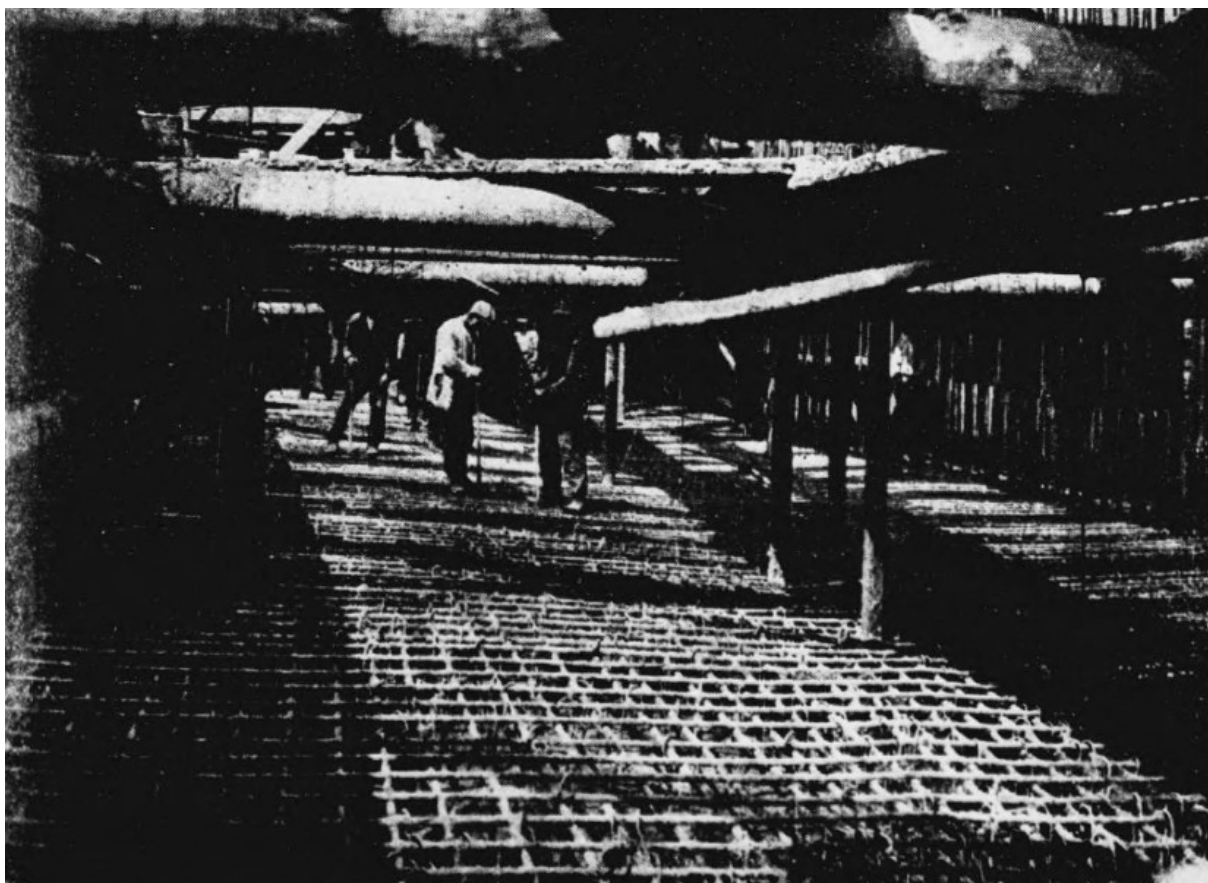
Obrázek č. 74: Kolín armatura základní desky pro pilř V., Technický obzor 1916 Tab. 30.–31.
