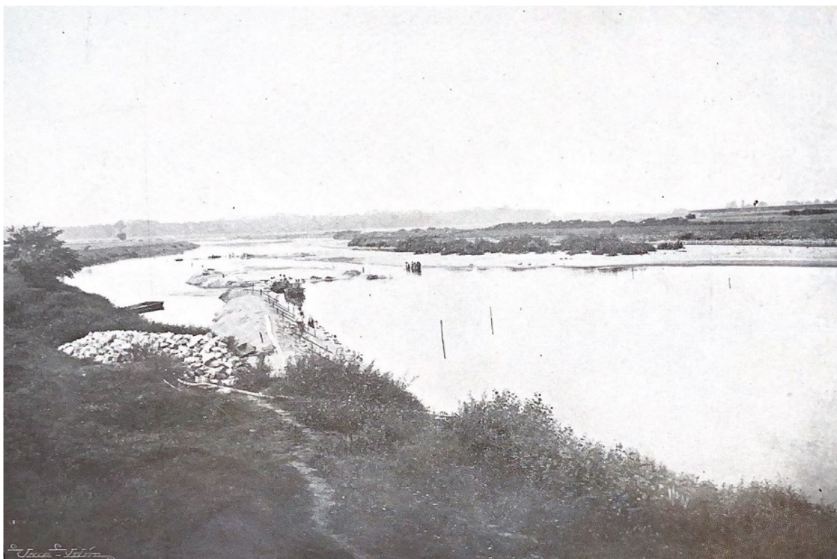
Obrázek č. 45: Pohled na počáteční stav prací u Litole, v druhé polovině července 1912, Střední Labe upravené a uplavněné : roč. 10, č. 8, s. 128.
