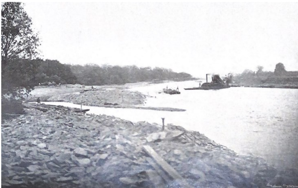
Obrázek č. 43: Pohled po proudu na práce ve spojovací trati labské u Válů, při zřizování levostranné hráze, Střední Labe upravené a uplavněné : roč. 10, č. 7, s. 114.
