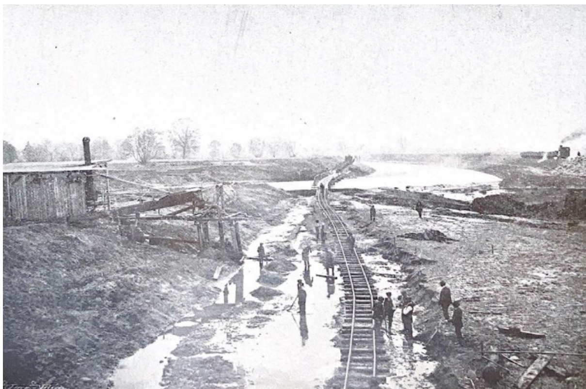
Obrázek č. 39: Pohled na zemní práce v průkopu 164 na ř. km Předměřice, říjen 1912, Střední Labe upravené a uplavněné : 1913, roč. 10, č. 7, s. 108.
