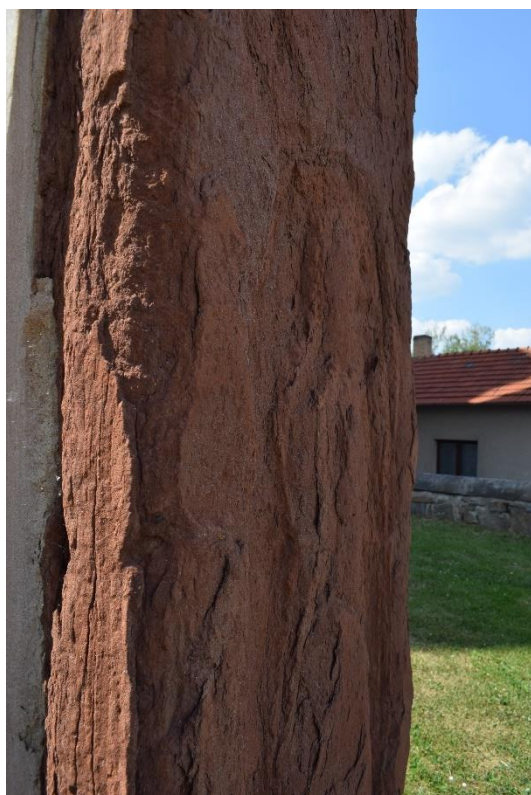
Obrázek 58 – Detail poškození náhrobníku vdovy Reginy
