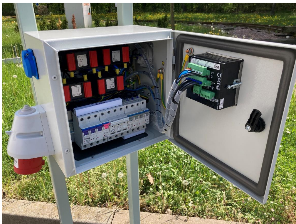
Obr. 31: Fotografie zapojeného rozváděče vzniklého měřicího pracoviště zpětných vlivů
