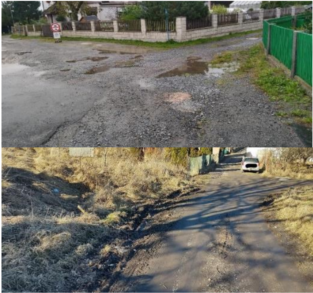
Obrázek 32: Nekvalitní povrch místní komunikace Klínek – č. II/306 směr Dřeveš (foto pořízené autorem)
