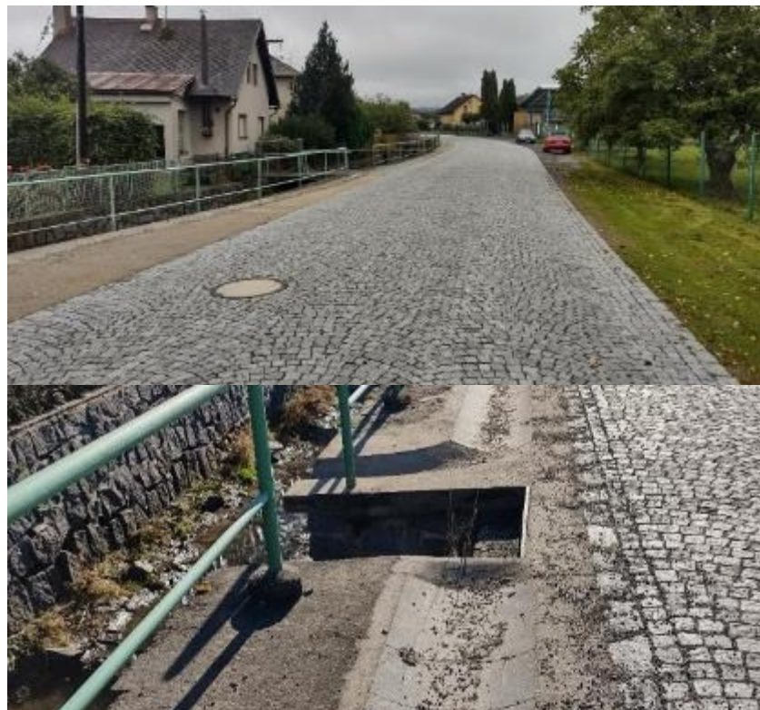
Obrázek 27: Absence chodníků k mateřské škole a žlab pro svod vody s přerušením (foto pořízené autorem)
