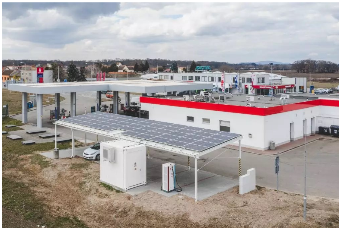
Obrázek 15 Dobíjecí stanice E.ON s fotovoltaickou elektrárnou a bateriovým uložištěm (E.ON Drive, 2021)
