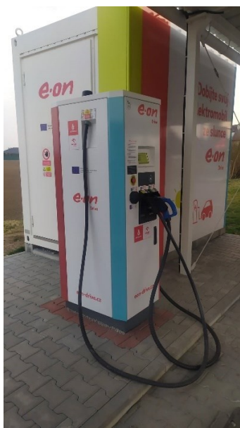
Obrázek 16 Dobíjecí stanice E.ON (autor, 2022)
