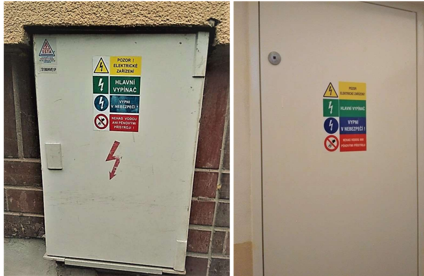
Obrázek 19 – Bezpečnostní značky – Hlavní vypínač elektro rozvodné skříně
