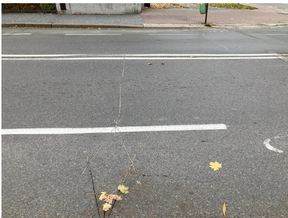
Obrázek A5 Indukční smyčka na Prokopově mostu
