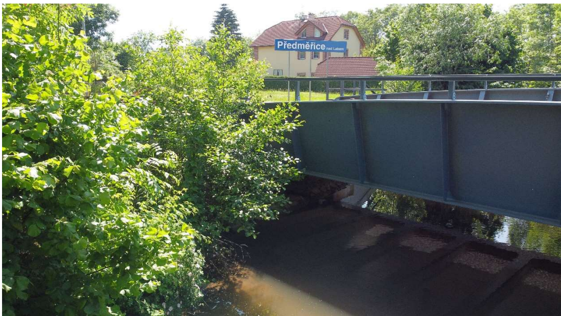
Obrázek 5 - Most s vylehčenou ocelobetonovou mostovkou (dle MVL 155 typ 7) v Předměřicích nad Labem
