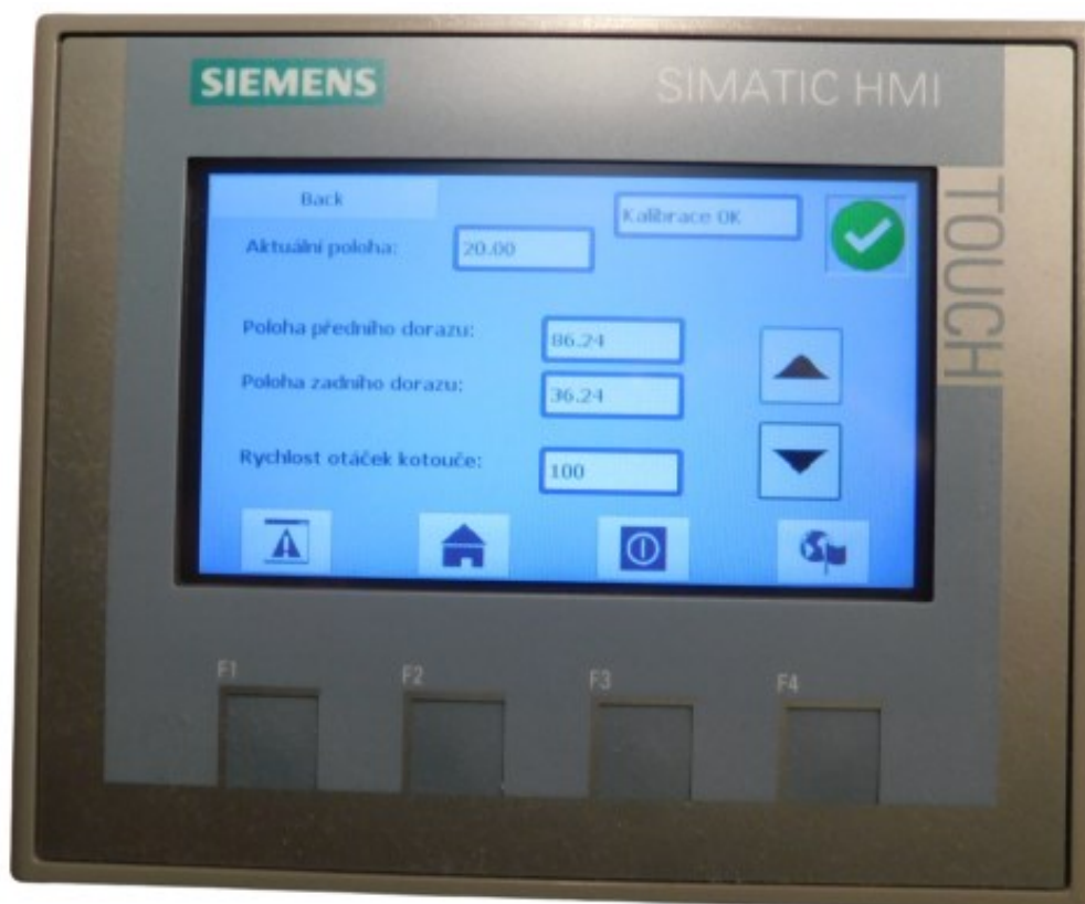
Obr. 2.27 – Obrazovka HMI displeje signalizující provedení kalibrace
