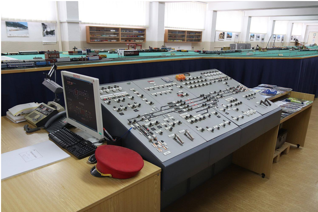
Obrázek 6 – reléové zabezpečovací zařízení
