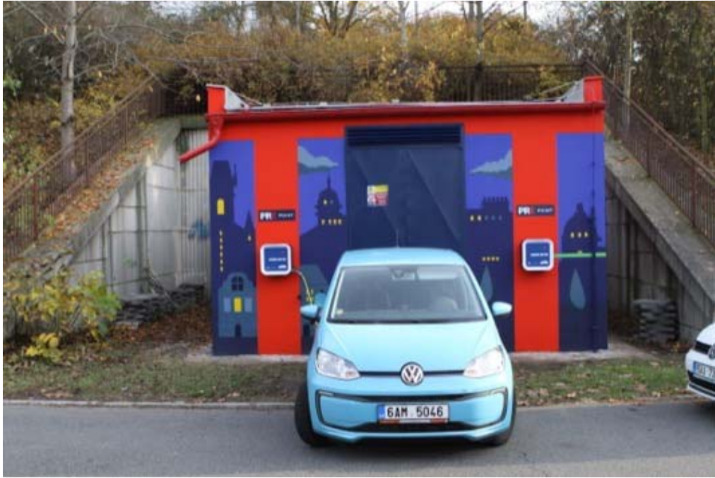
Obr. 8 Nástěnné dobíjecí stanice tzv. "wallboxy" na distribuční stanici [12]
