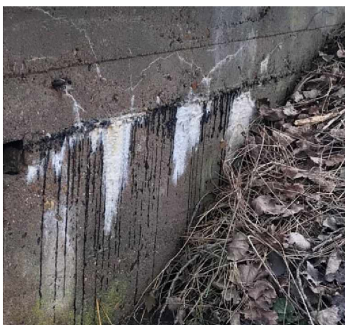
Stopy po zatékání, výluhy
