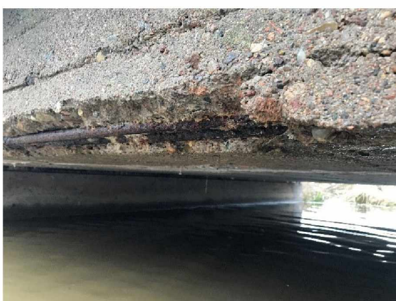
Chybějící krycí vrstva, výztuž napadená povrchovou korozi
