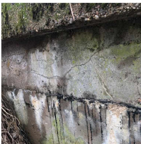
Praskliny na pravé straně NK
