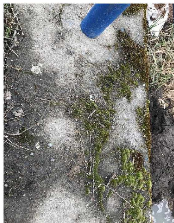
Povrch levé i pravé římsy začíná degradovat a je porostlý mechem
