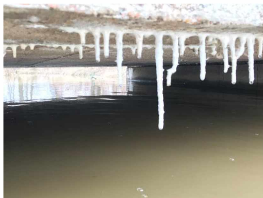
Stopy po zatékání, výluhy, krápníky
