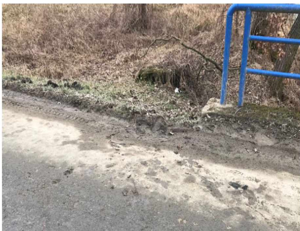
Drobné nerovnosti na kraji vozovky před/za mostem
