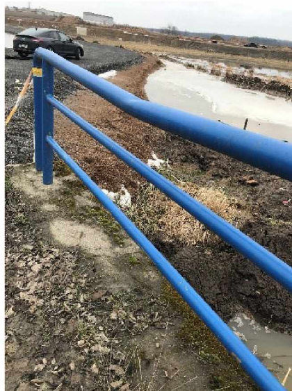
Zdeformované madlo zábradlí
