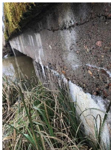
Praskliny na levé straně NK
