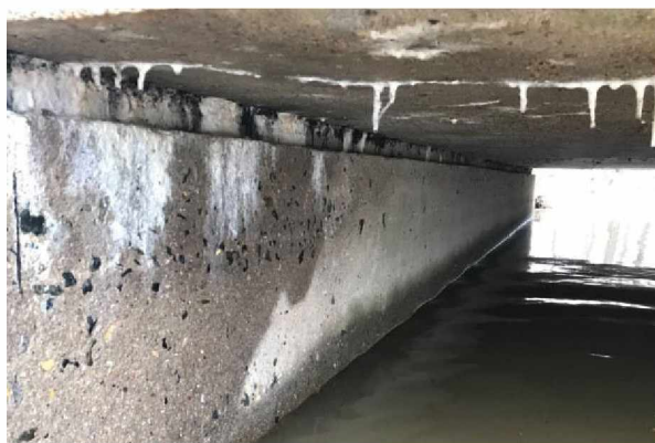
Stopy po zatékání, výluhy, krápníky
