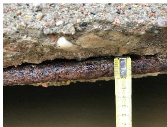
Chybějící krycí vrstva, výztuž napadená povrchovou korozi
