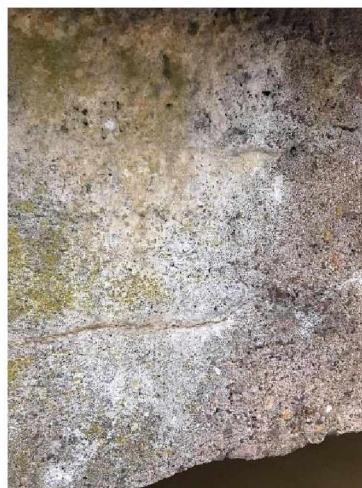
Prasklina na levé straně NK
