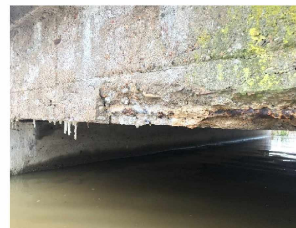
Chybějící krycí vrstva, výztuž napadená povrchovou korozi
