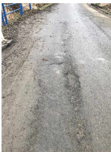
Výtluky a nerovnosti na vozovce za mostem
