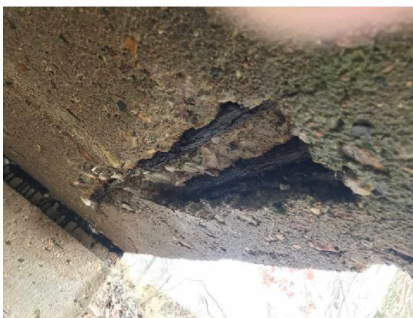
Chybějící krycí vrstva, výztuž napadená povrchovou korozi
