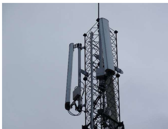
Obrázek 17 - Ukázka panelových antén umístěných na obdobném stožáru [27]
