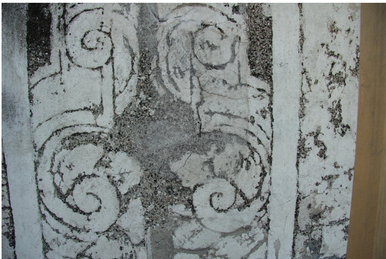
Obr. 56: V ploše sgrafita byly v minulosti při v rámci restaurátorských zásahů vytvořeny „plomby“, které měly uchytit uvolňující se originální vrstvy omítky. Tyto plomby jsou vzhledem k značnému vyduťtí buďto vypraskané a vypadlé nebo byly odtrženy od originální vrstvy.
