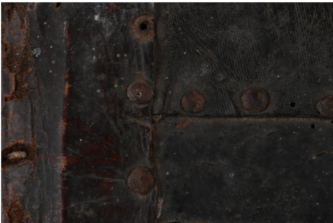
Obrázek 37 Pohled na železné hřebíčky před restaurováním
