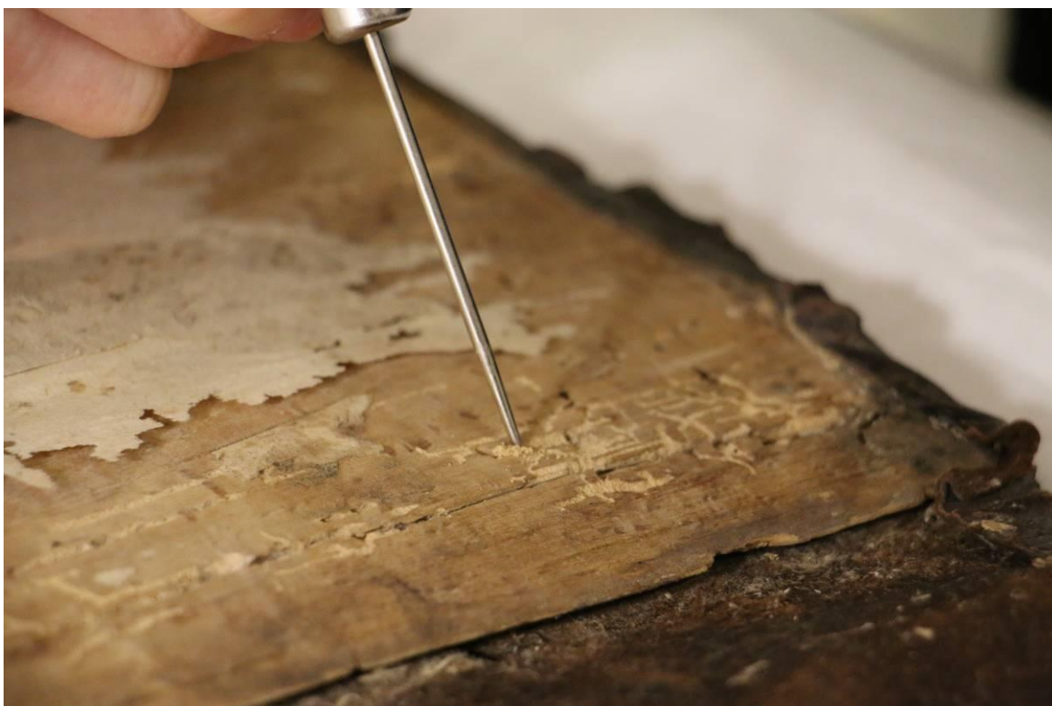
Obrázek 80 Odstraňování odpadové drti z chodbiček vyhloubených dřevokazným hmyzem
