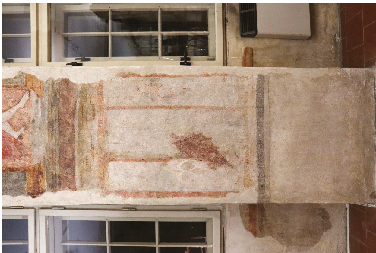
Obr. 64: Sekvence, stav díla před restaurováním v rozptyleném umělém bílém světle. Spodní část restaurovaného úseku.
