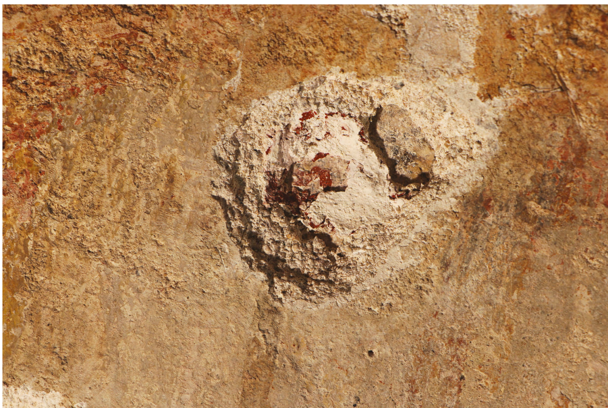
Obr. 41: Průběh odstraňování druhotných tmelů v ostrém bočním nasvícení. Detail obnaženého zdiva po odstranění tmelu z peku.
