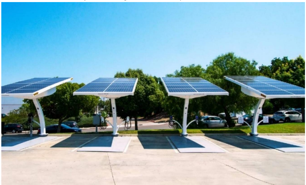
Obrázek 5.1 – solární nabíjecí stanice pro elektromobily [40]
